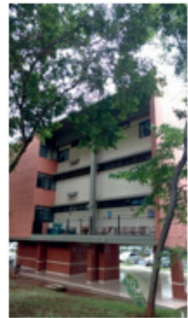
Figura 206 – Fachadas Oeste de edifício RE com alterações que pouco comprometem a composição arquitetônica e que dão nova dinâmica a essa face do conjunto.
