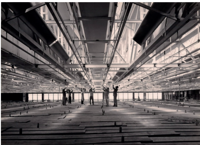
Figura 132 – Foto da montagem da estrutura metálica do grande vão (32 m) da cobertura do térreo do Sede I, em 1959/60. Essa imagem simboliza as contradições da instauração de Brasília: a modernidade na forma e no discurso e o modo quase artesanal de execução dos trabalhos. Fonte: Marcel Gautherot, IMS.
