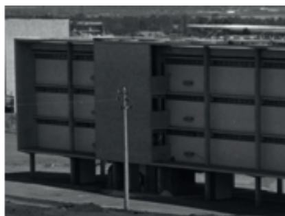
Figura 204 – Fachada posterior original(esquerda) e fachada alterada sobre a marquise do pilotis de forma que compromete a volumetria e a composição do edifício (direita). Fonte : ArPDF.
