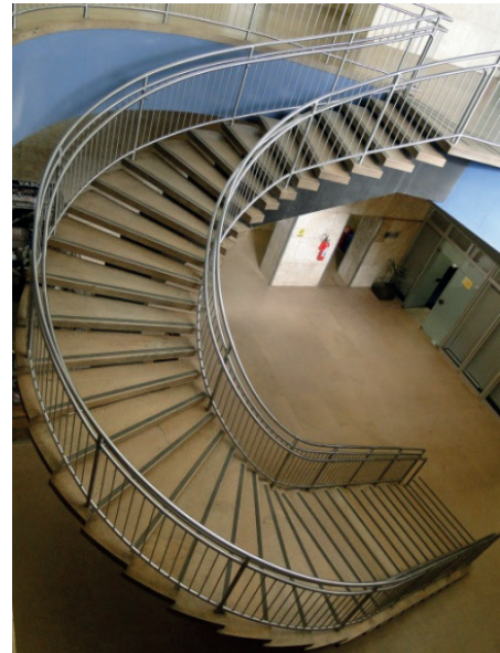
Figura 127 – Escada 2º subsolo – alteração do corrimão - normativos de segurança e acessibilidade demandando alterações. Fotos: à esquerda, Marcel Gautherot (1960) /Acervo IMS; à direita, JWL (2012).
