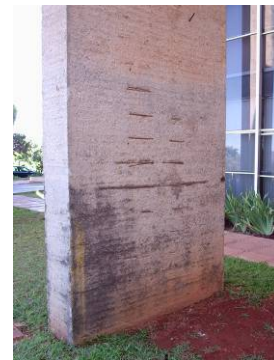
b) Pilar externo – fachada norte Cobrimento deficiente - F_i = 3 Manchas superficiais - F_i = 2
