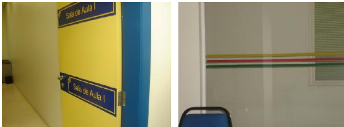
Fotografia 29. Marcos de portas e faixa sinalizadora nas paredes de vidro
