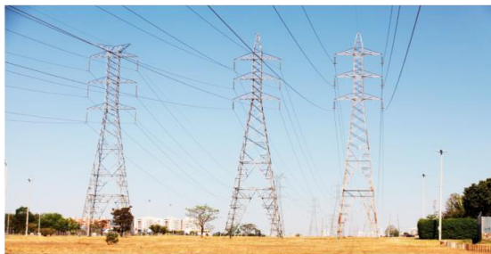
Fotos 03: Rede de alta tensão de FURNAS. Washington Candido, agosto de 2017.
