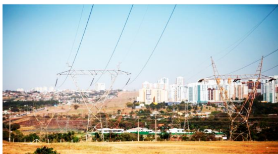
Fotos 04: Rede de alta tensão de FURNAS. Washington Candido, agosto de 2017.
