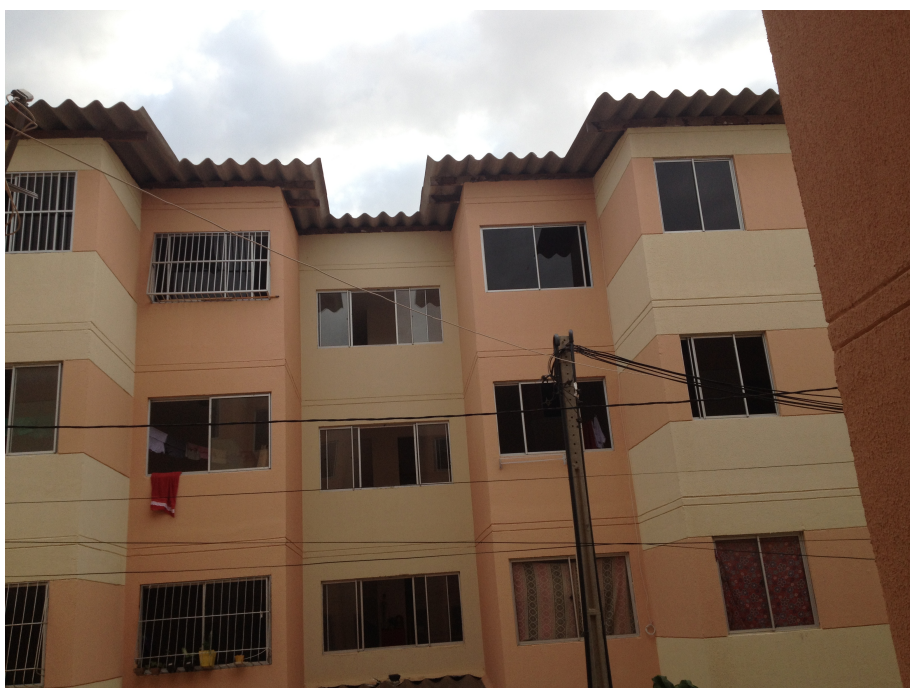
Figura 21: Um dos primeiros blocos concluídos no Residência Cidade jardim. Fonte: acervo do autor.
