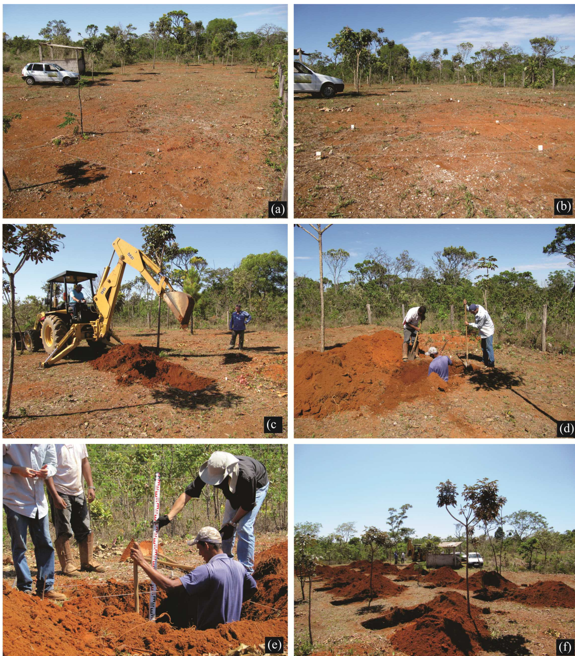
Figura 2.8 – Fotos da área do SCGF-UnB. (a) Antes das escavações com (b) detalhe das demarcações dos limites das covas. Durante (c) escavação com retroescavadeira e (d) correção das bordas e fundo das covas com detalhe de (e) uso de régua topográfica para controle da profundidade. (f) Após as escavações.
