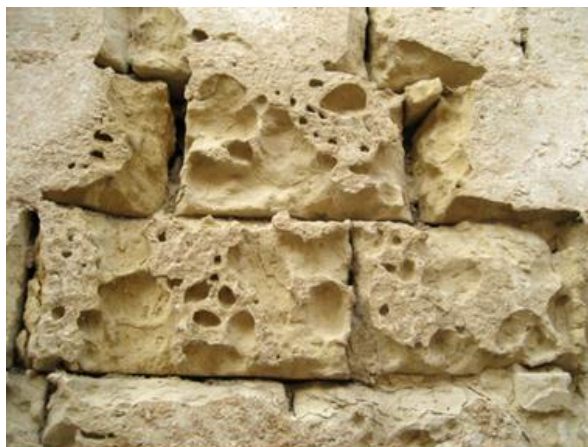
Figura 9 - Parede de pedra corroída pela chuva ácida.
