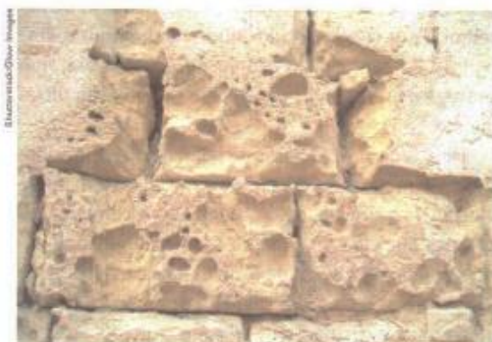
Figura 20.2 Na foto, parede de pedra corroída pela chuva ácida.
