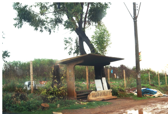
Figura 25 - Ponto de ônibus deteriorado Fonte: Autora (Fotos em 17.11.2017).
