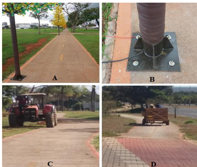
Figura 4.39: Ilustrações de uso indevido das ciclovias: A e B – colocação de decoração natalina sobre a ciclovias do Eixo Monumental; C – tráfego de máquinas pesadas sobre o pavimento rígido da ciclovias da UnB; D – tráfego de transporte de tração animal sobre a ciclovias da L3 norte
