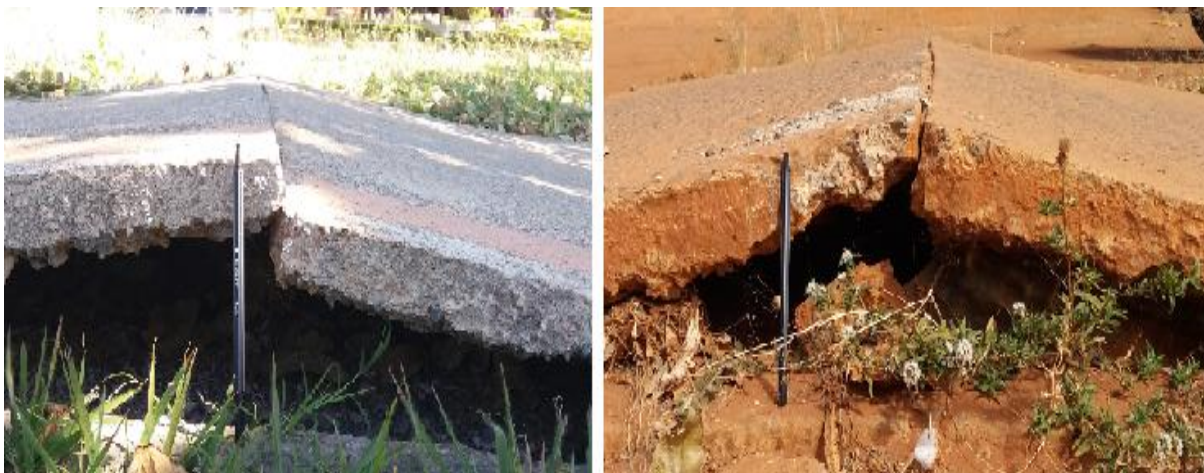
Figura 4.36: Imagem das placas de concreto com menos de 8cm de espessura
