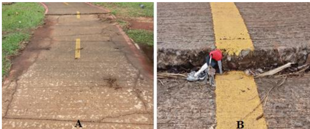
Figura 4.38: Ciclovias degradada causada pelo tráfego de automóveis ( A – local de tráfego de automóveis; B – rompimento da placa na junta)
