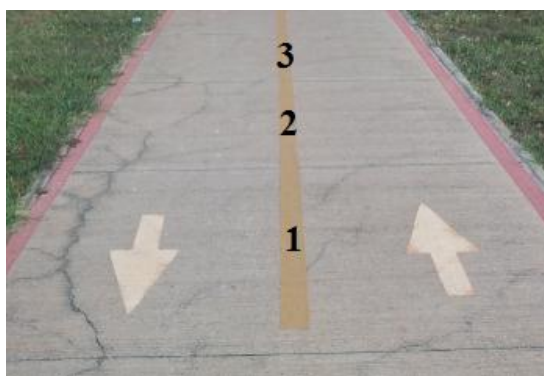
Figura 3.3: Ilustração da sequência de placas ( 1; 2; 3) de uma determinada ciclovia através da separação pelo corte das juntas
