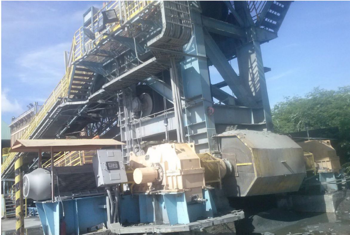
Figura 3.1 - Redutor do transportador de correia TAG 16TR503.
