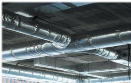
Figura 1: Sistema de dutos HVAC aplicado na indústria (adaptado de ISOVER [3]).
