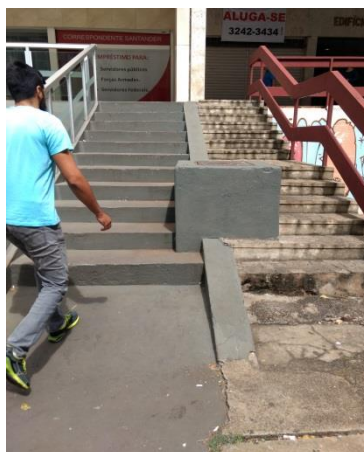
Figura 53: Barreiras do Setor Comercial Sul (Fonte: Própria)
