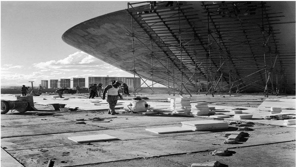
Figura 41- Cúpula da Câmara dos Deputados, em fase de concretagem, com os ministérios ao fundo. Brasília, 1959. Foto: Marcel Gautherot/IMS.
