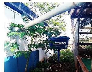
Captação de águas pluviais
