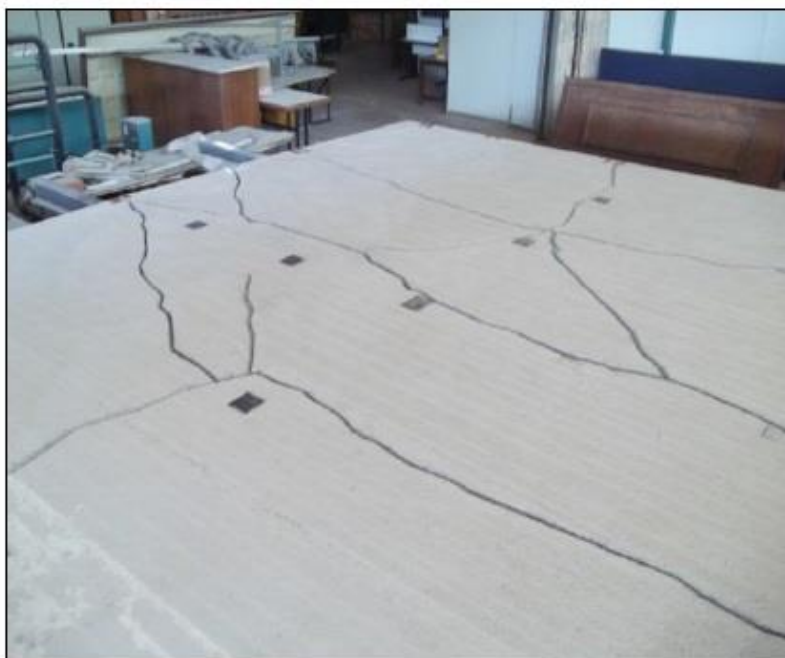
Figura 5.4 – Trincas na laje que foram preenchidas com graute epóxi fluido (Campuzano, 2016).
