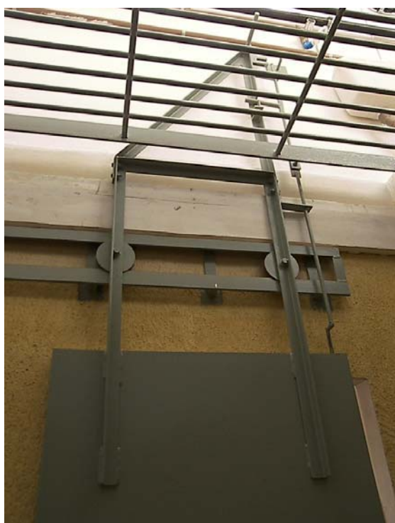
Figura 72 – Porta corredeira com acionamento pelo piso superior
