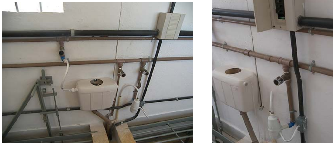
Figura 79 – Instalações Hidráulicas e Elétricas controladas pelo agente
