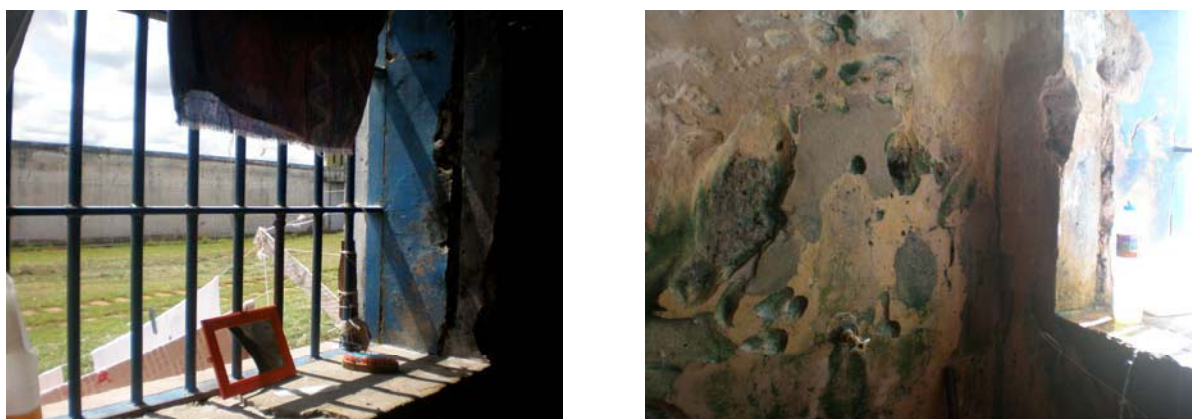
Figura 100 – Condições precárias das grades e das paredes
