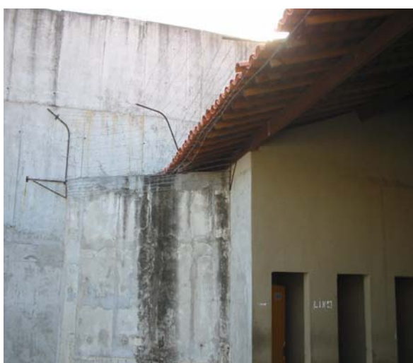
Figura 47 – Arame farpado além do beiral para evitar que os presos subam no telhado
