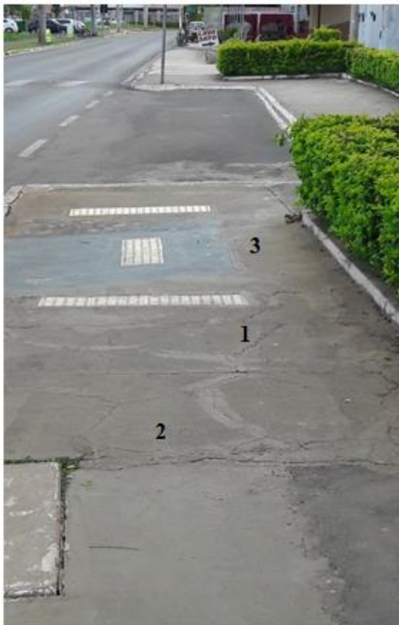
Figura 30 - Calçada não acessível. (Autor, 2018)
