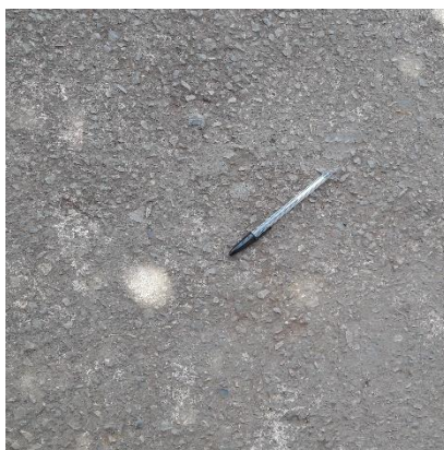
Figura 07 - Desgaste superficial. (Autor, 2018)
