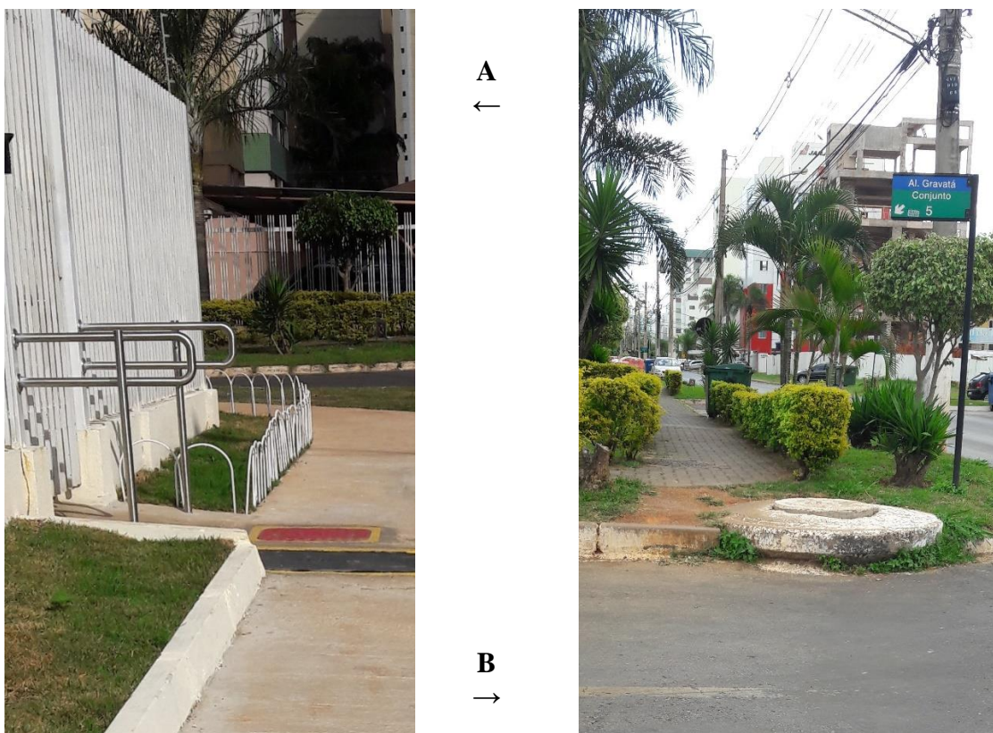
Figura 28 - A: Acesso a edificação; B: Calçada sem continuidade. (Autor, 2018)
