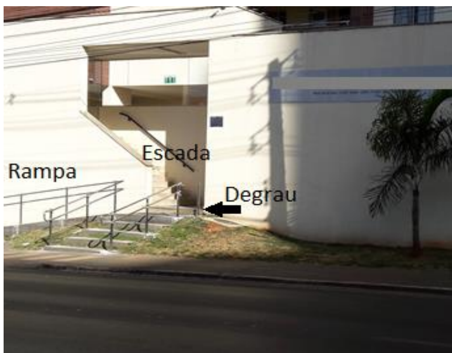
Figura 46 - Exemplo de falta de acessibilidade no acesso principal de moradia multifamiliar. (Autor, 2018)
