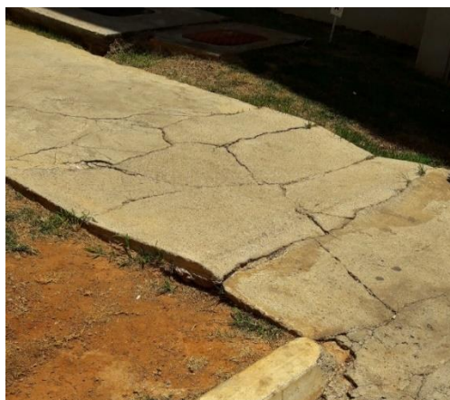
Figura 69 - Exemplo de rota acessível com revestimento em grave estado de degradação. (Autor, 2018)
