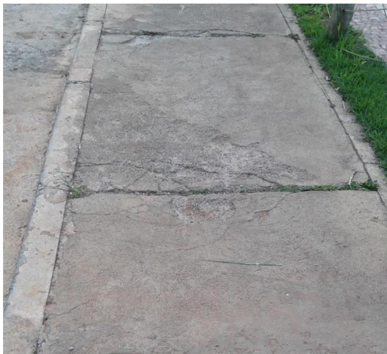
Figura 83 - Exemplo de calçada inacessível em razão do grau de degradação do concreto. (Autor, 2018)
