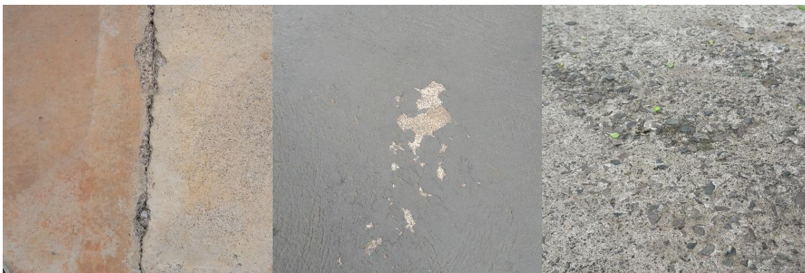
Figura 57 - Exemplos de manifestações patológicas esborcinamento, delaminação e desgaste, Área 02. (Autor, 2018)
