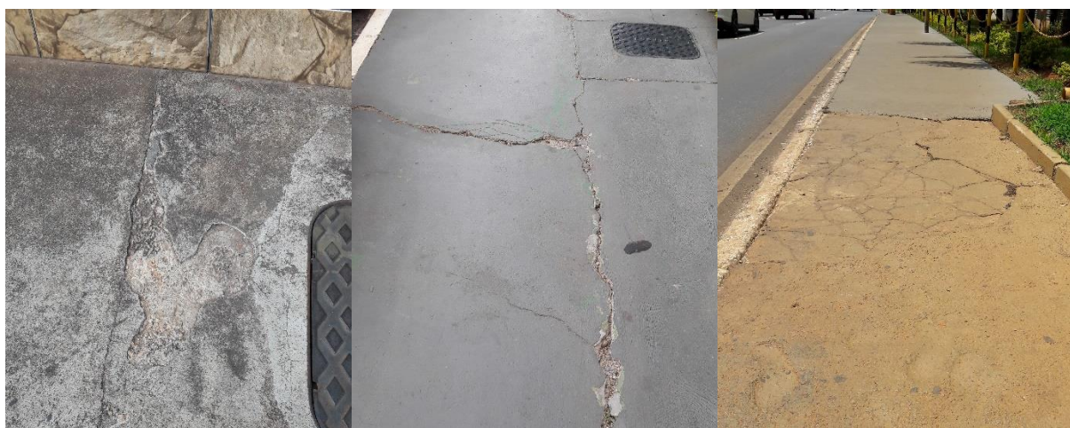
Figura 42 - Manifestações patológicas do concreto: delaminação, desgaste, fissuras, recalques. (Autor, 2018)
