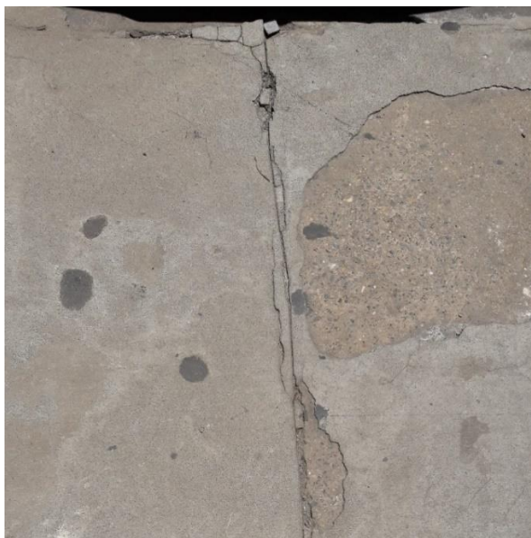
Figura 70 - Exemplo de calçada com patologias superficiais, esborcinamento e delaminação. (Autor, 2018)
