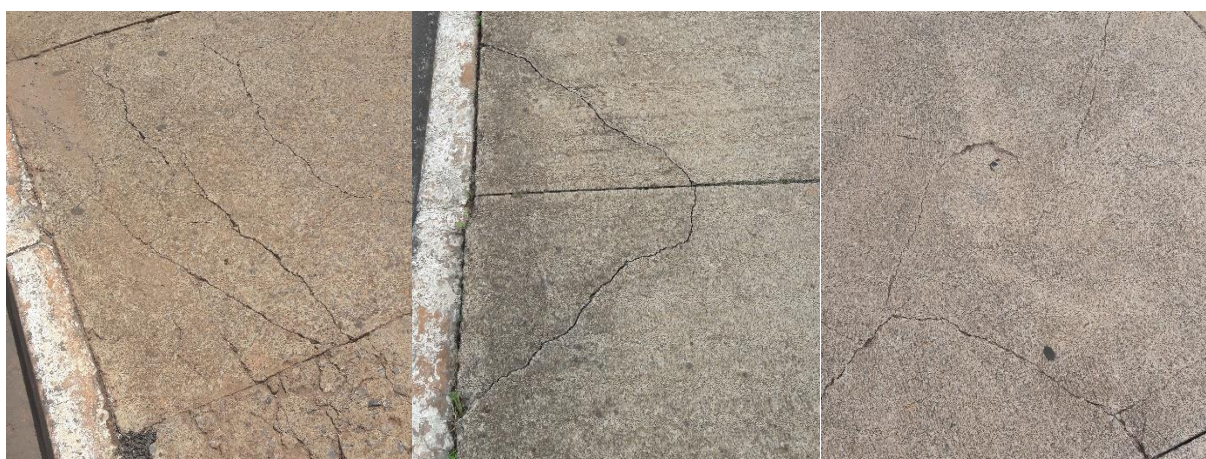
Figura 58 - Exemplos das formas de manifestação de fissuras: longitudinais, canto e malha. (Autor, 2018)
