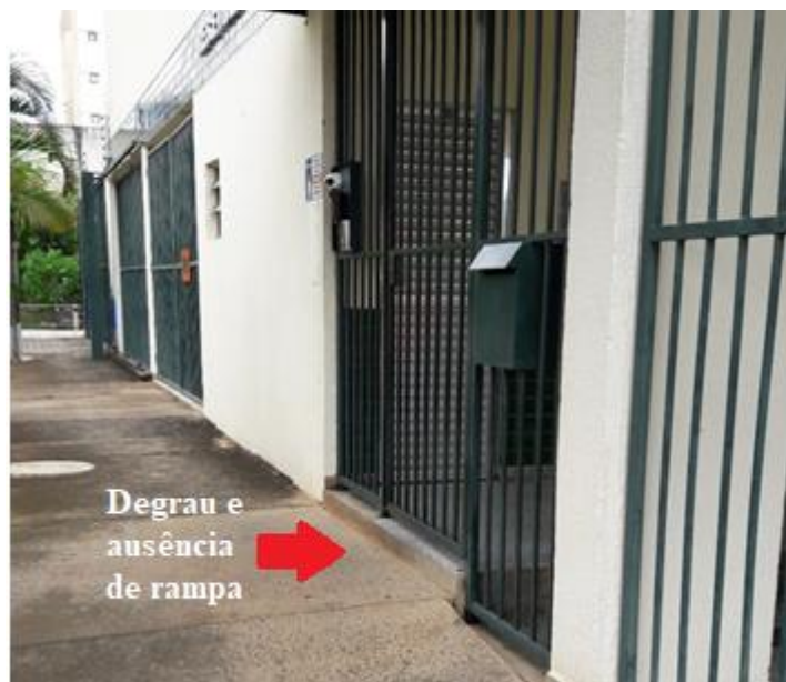
Figura 76 - Exemplo de acesso principal inadequado. Desnível superior a 20 mm. (Autor, 2018)
