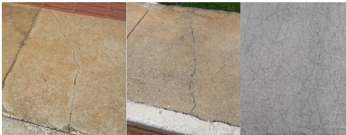
Figura 44 - Apresentação de algumas manifestações de fissuras na Área 01. (Autor, 2018)
