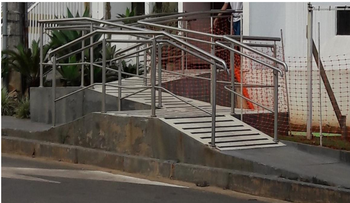
Figura 32 - Rampas de acesso com inclinações inadequadas, interrompendo do fluxo livre da rota acessível. (Autor, 2018)
