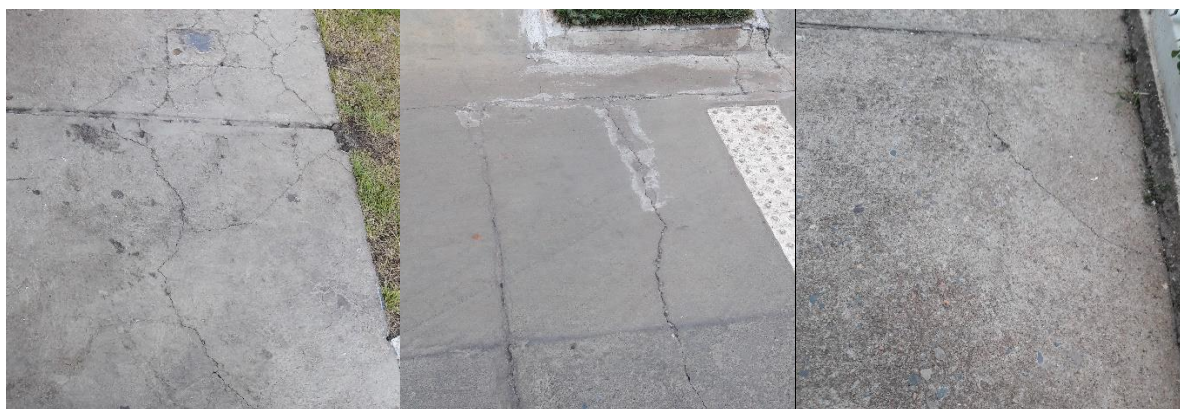
Figura 82 - Exemplo de manifestações patológicas: fissuras e desgaste superficial. (Autor, 2018)
