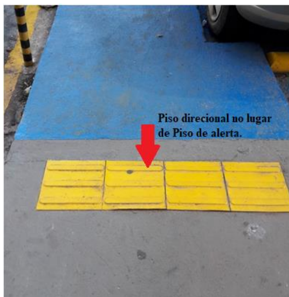
Figura 50 - Exemplo de utilização inadequada de piso tátil. (Autor, 2018)
