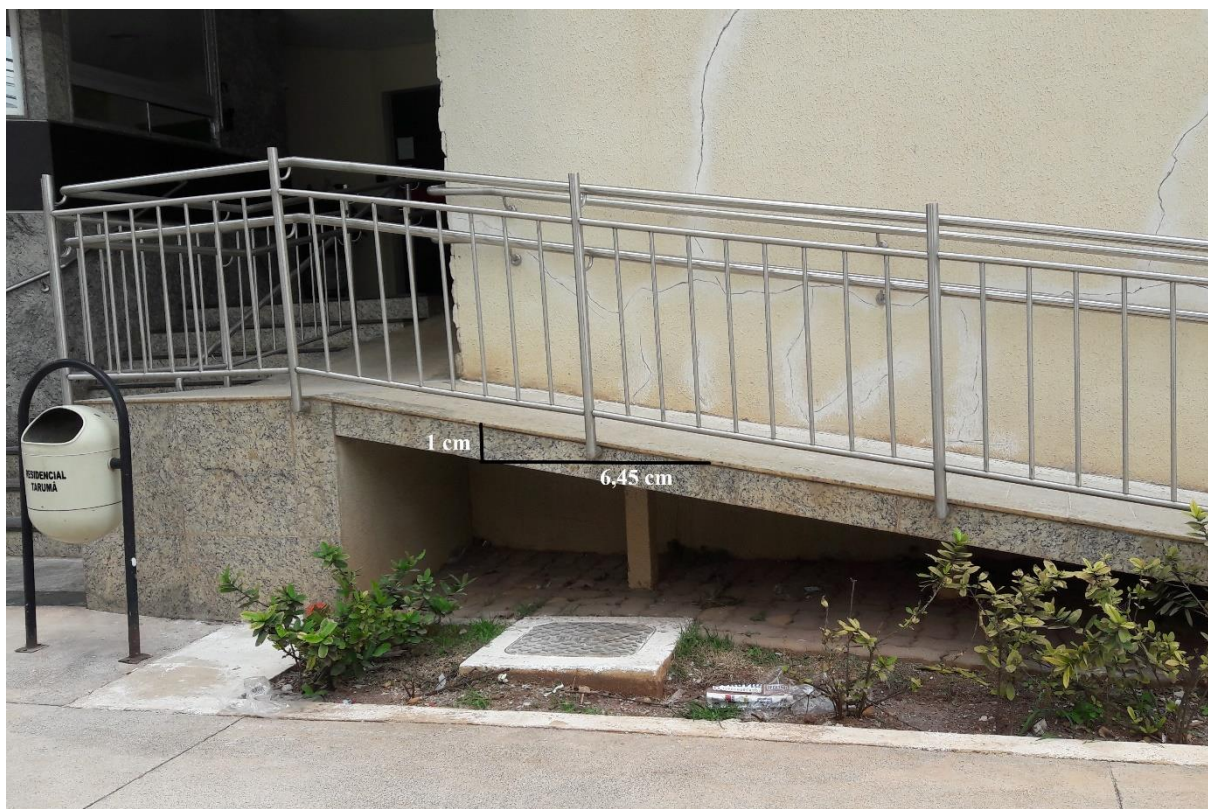
Figura 60 Exemplo de acesso principal inadequado, inclinação superior a 8,33%. (Autor, 2018)
