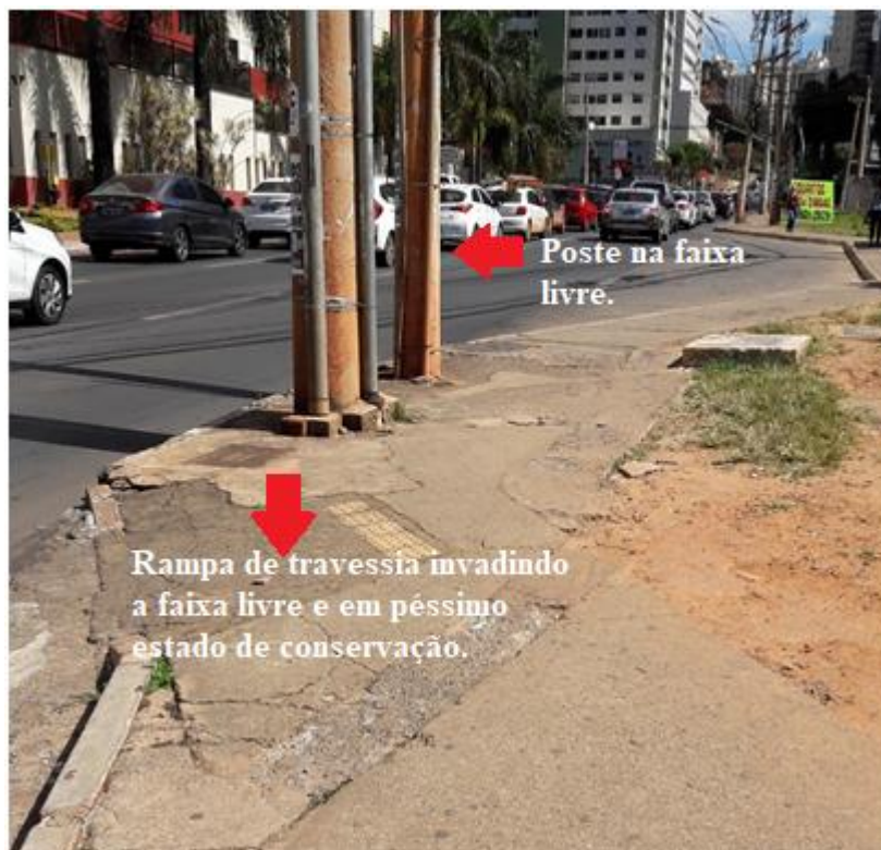
Figura 52 - Exemplo de calçada inacessível, área 02. (Autor, 2018)
