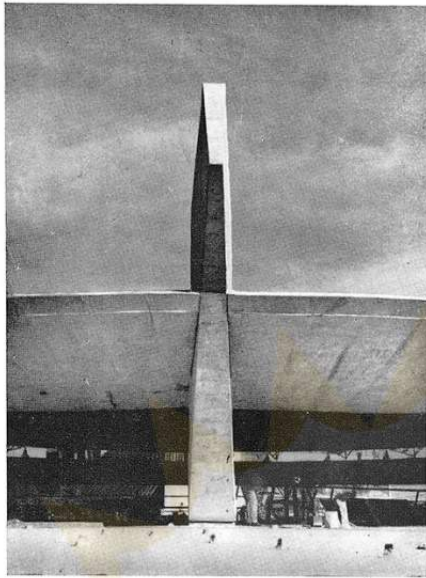
Os elementos estruturais de concreto não foram revestidos. Há articulações da estrutura de cobertura com a marquise
