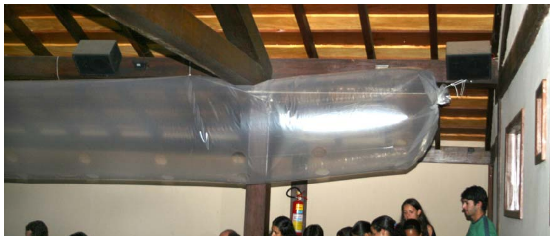
Figura 19. Detalhe do forro e duto do ar condicionado, cinema, 2006. Foto: KlikFoto/Nivaldo.
