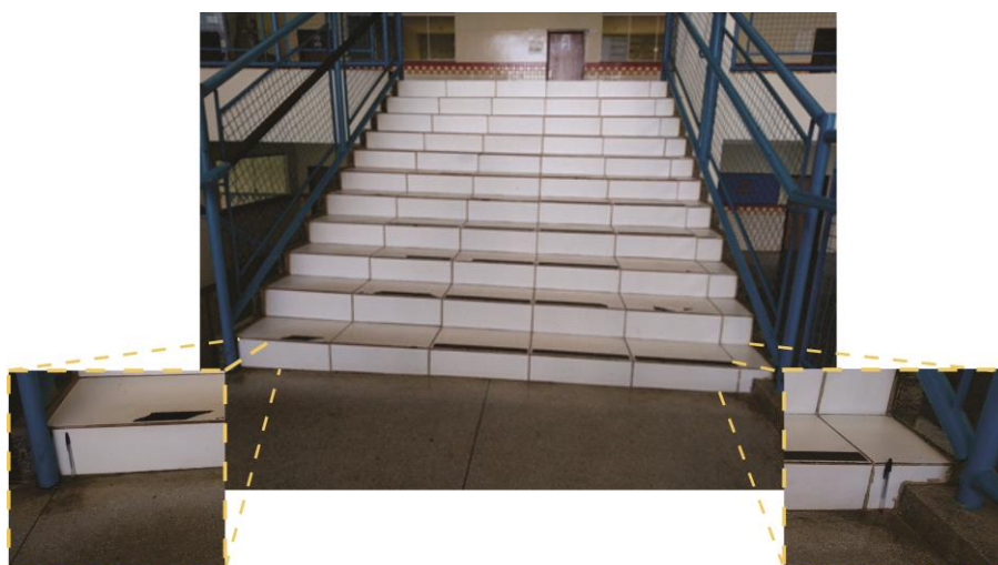
Figura 32 – Inconstância entre pisos e espelhos na escada de acesso ao pavimento superior do bloco de salas de aula da escola 01.
