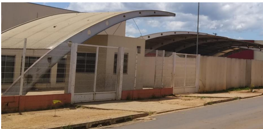
Figura 33 – Desníveis, ausência de pavimento e regularidade da superfície da circulação da calçada no local de acesso dos alunos à unidade escolar 01.
