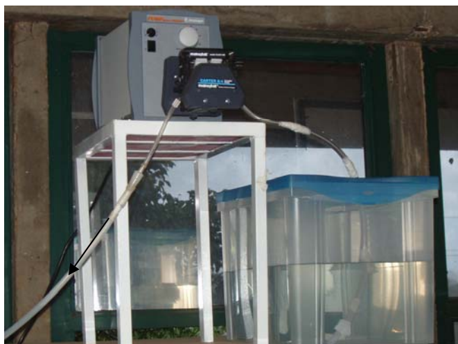
Figura 4.5 – Reservatório de coagulante e bomba dosadora
