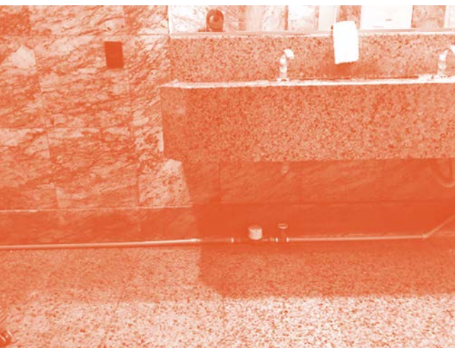
Figura 3.110: Tubulação hidráulica improvisada em banheiro público – Fonte: Anderson Ferreira, 2019.
