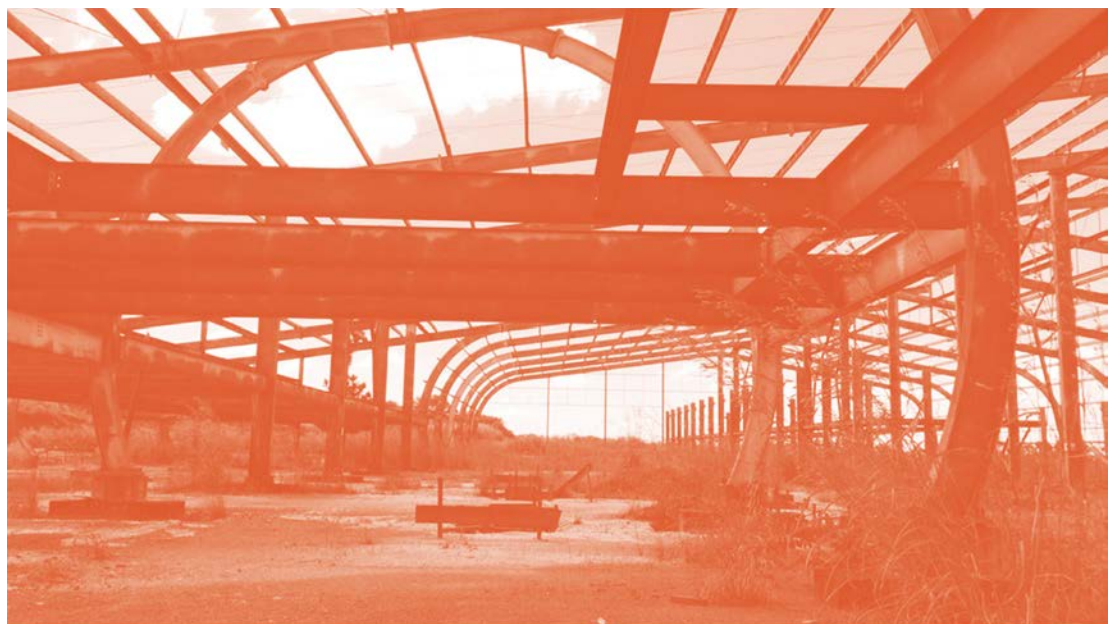
Figura 3.39: Obras abandonadas do Terminal do VLT - Fonte: https://g1.globo.com/df/distrito-federal/noticia/obras-prometidas-em-brasilia-para-a-copa-de-2014-chegam-a-copa-de-2018-paradas-veja-lista.ghtml .
