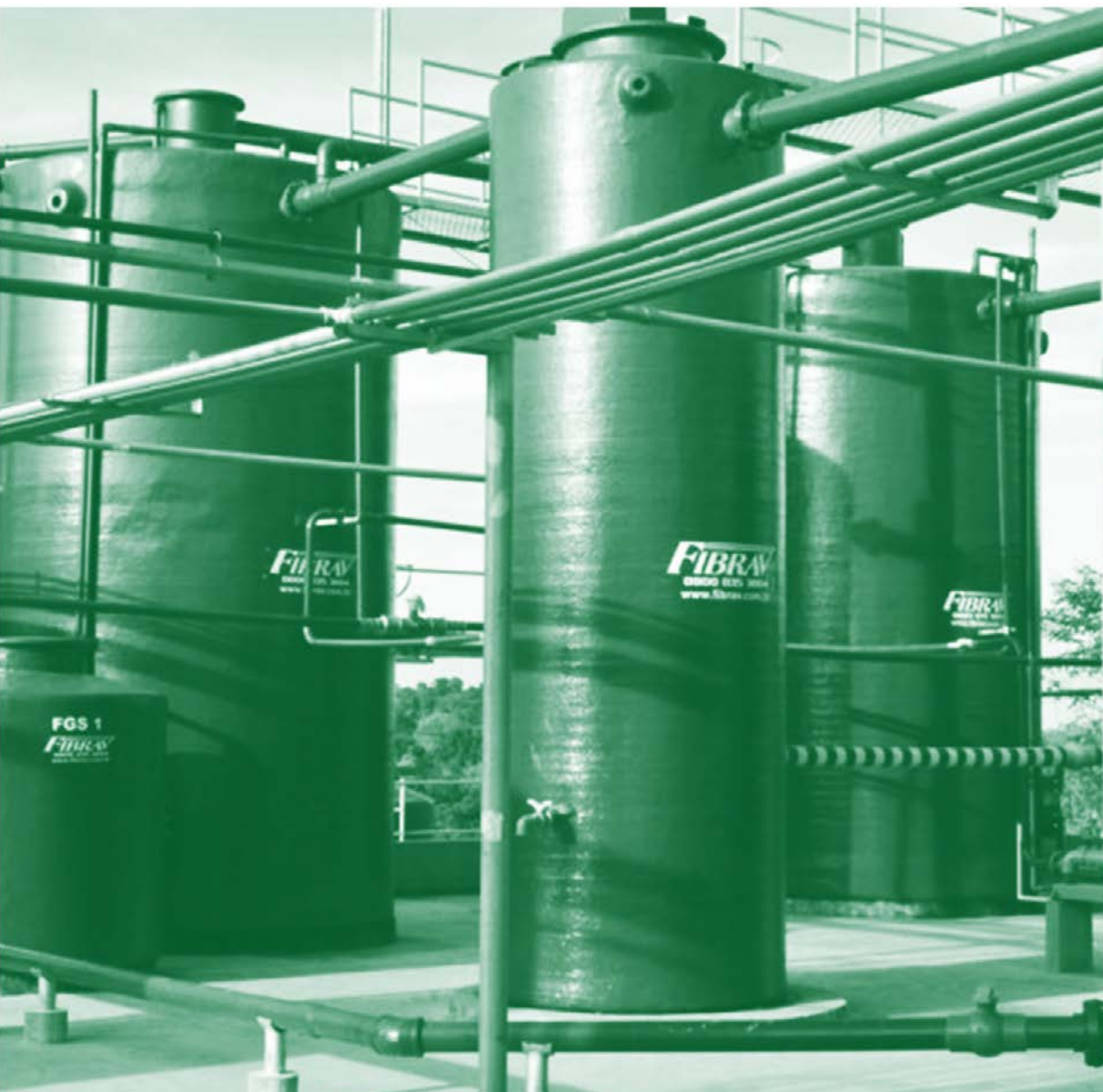
Figura 1.10 - Estação de Tratamento de Esgoto Industrial. Fonte: http://www.fibrav.com.br/produtos/saneamento-estacoes-de-tratamento/estacao-de-tratamento-de-esgoto-industrial/ .
