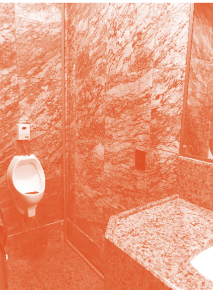
Figura 3.109: Tubulação hidráulica improvisada em banheiro público – Fonte: Anderson Ferreira, 2019.
