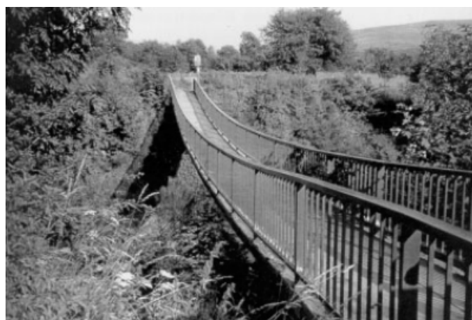
Figura 2.3 – Passarela em forma de curva catenária. Hope Valley, Reino Unido (Pimentel, 1997).
