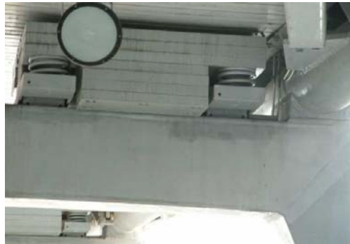
Figura 5.2 - AMS instalado na Passarela Millennium.
