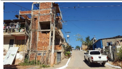
Foto 13 – Ausência de drenagem pluvial, construção de edifício com vários pavimentos, sem identificação de responsável técnico e apresentando falhas estruturais.
