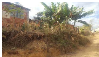
Foto 12 – Residências próximas a taludes, sem drenagem de águas pluviais.
