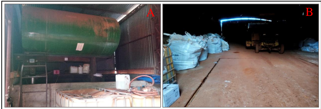
Figura 23 - A) Depósito de tanque de combustível da Fazenda Cachoeira; B) Caneletas no piso do depósito do tanque de combustível para impedir escoamento de óleo no solo Trabalho de Campo (2019)
