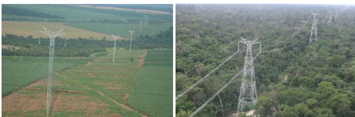
Figura 3.3 – Linhas de Transmissão \pm 600 kV Coletora Porto Velho / Araraquara 2. Fonte: Eletronorte
