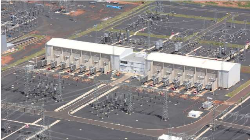
Figura 3.4 – Bipolo 1 do Complexo HVDC do Madeira na SE Araraquara 2 Fonte: Eletronorte
