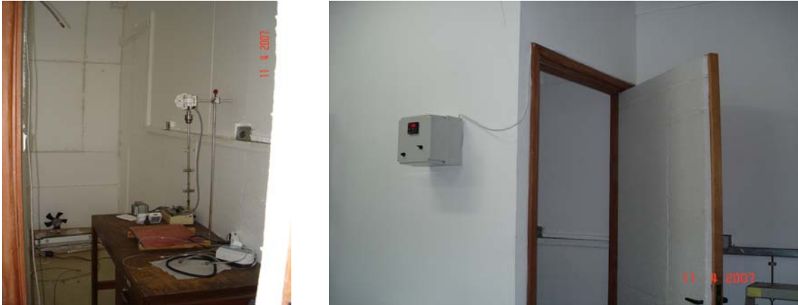
Figura 4.5 – Câmara climatizada para controle da temperatura
