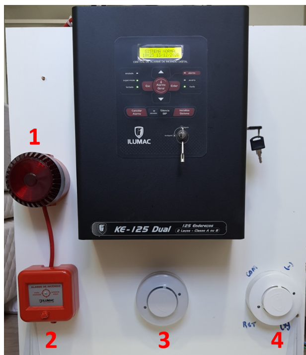
Figura 3.1: Laboratório central de alarme de incêndio
