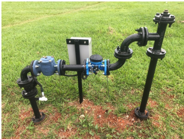
Figura 5. Cavalete com hidrômetro ultrassônico instalado na saída sul do ICC.
