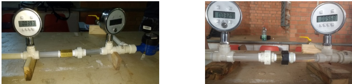
Figura 22 – Bancada em teste com os manômetros e o bloqueador de ar Air Bloch (em latão).
