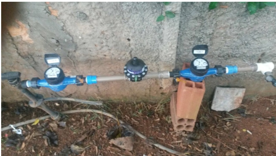
Figura 32 – Cavalete com a instalação do eliminador de ar (Dolphin) em campo.
