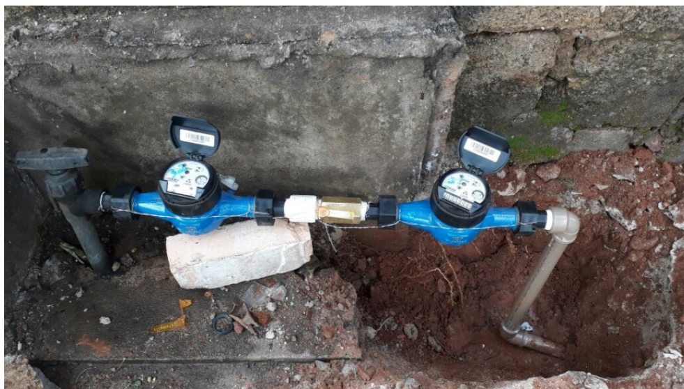
Figura 35 – Cavalete com a instalação do bloqueador de ar HG (em latão) em campo.
