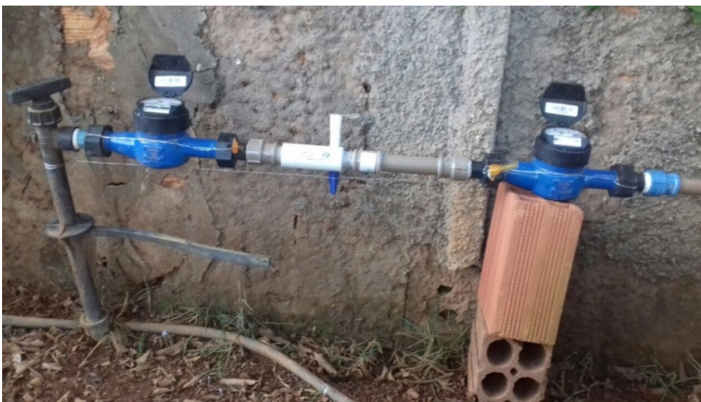
Figura 33 – Cavalete com a instalação do eliminador de ar HG (em PVC).
