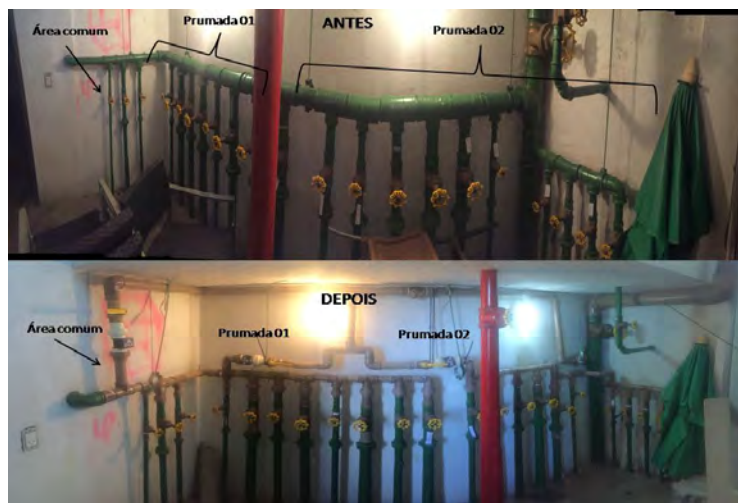
Figura 2. Setorização de medição em um barrilete de condomínio residencial
