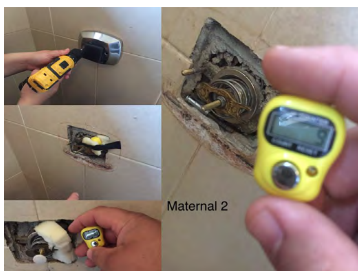
Figura 4. Instalação de contadores analógicos em válvula de descarga
