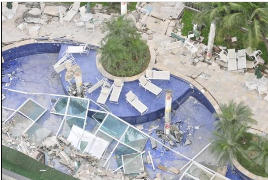
Figura 1.4 – Acidente ocorrido no condomínio Grand Parc, na Enseada do Tauá, Vitória ( https://www.gazetaonline.com.br/noticias/cidades/2016/07/como-a-area-de-lazer-do-grand-parc-desabou-1013960061.html )
