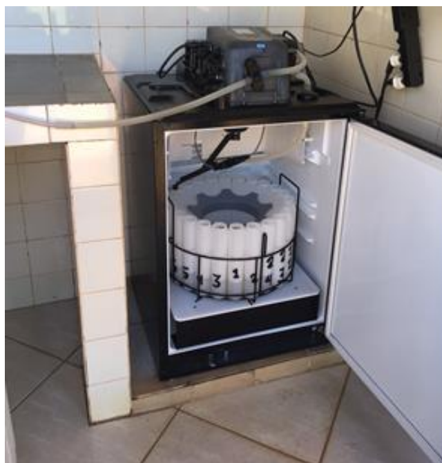
Figura 12. Amostrador automático (HACH, Colorado, USA) utilizado na coleta das amostras nas estações de tratamento de esgoto.
