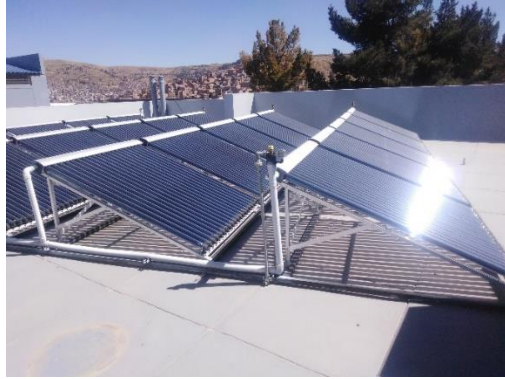
Calentadores solares de agua, instalados en la azotea
