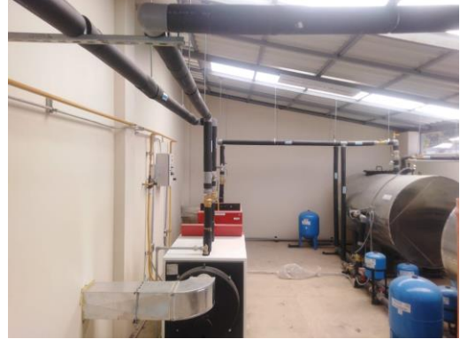
Sala de máquinas del sistema de almacenamiento y bombeo de agua
