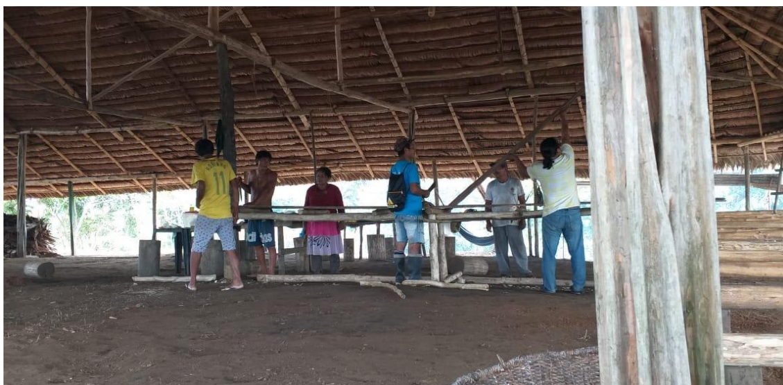
Figura 10: Na maloca dos Magüta, em construção na comunidade Mecürane. Fonte: Dados da pesquisa, Felipe 2019.
