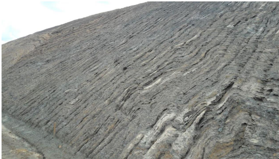
Figura 2.7. Processos erosivos na face do talude sul.
