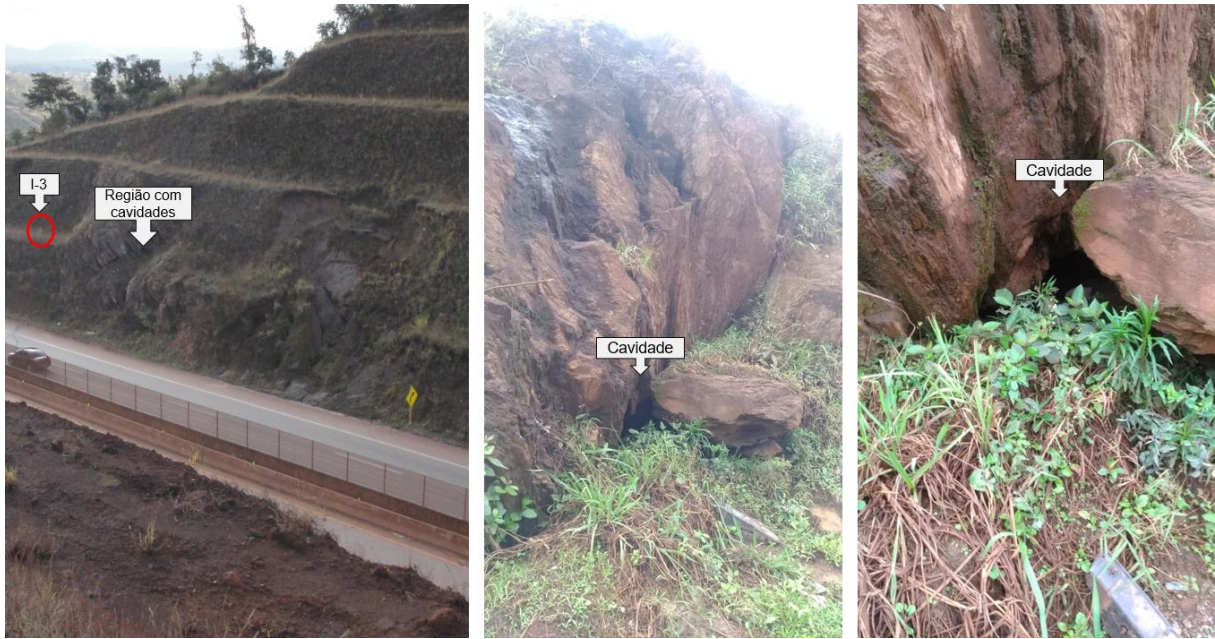
Figura 5.26. Cavidade verificada no afloramento rochoso do talude norte.
