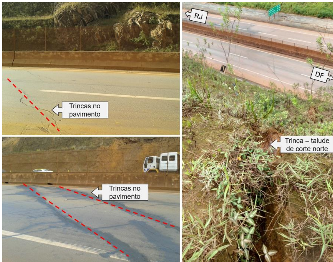
Figura 3.5. Trincas no talude de corte norte e no pavimento.
