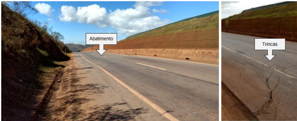
Figura 5.30. Deformações trincas no pavimento na direção do afloramento rochoso com presença de cavidade.
