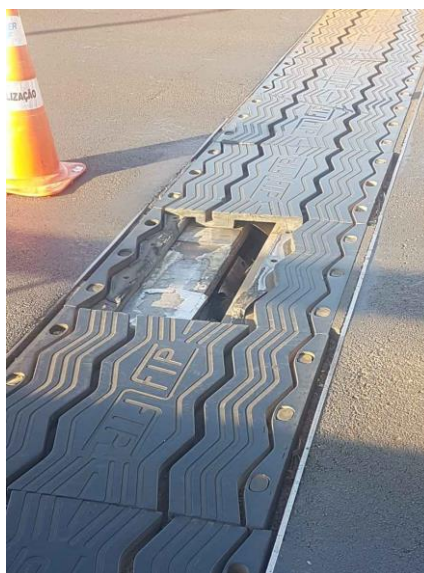
Figura 19: Junta de dilatação da ponte JK sem placa de proteção
