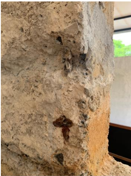
Figura 67. Armação exposta e corroída; desagregação.
