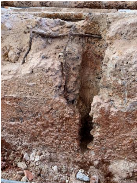
Figura 31. Armadura exposta e corroída; cobrimento deficiente; desagregação; deslocamento.
