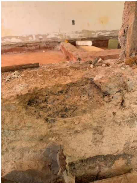
Figura 95. Desagregação; deslocamento; falhas de concretagem.
