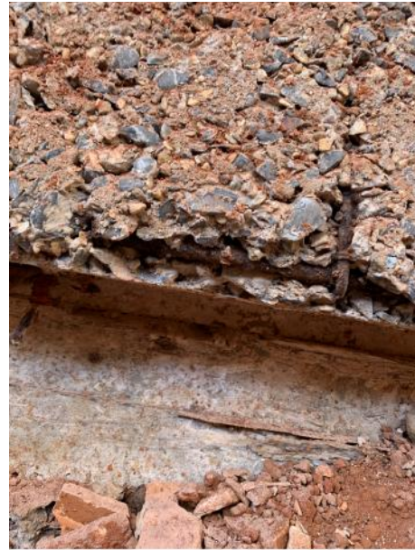
Figura 34. Armadura exposta e corroída; cobrimento deficiente; falha de concretagem.
