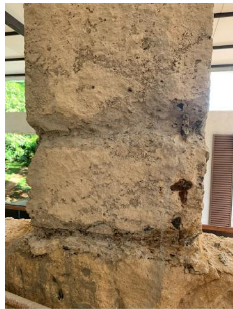
Figura 68. Armação exposta e corroída; desagregação.
