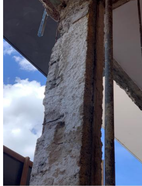
Figura 14. Armadura exposta; cobrimento deficiente; desagregação.
