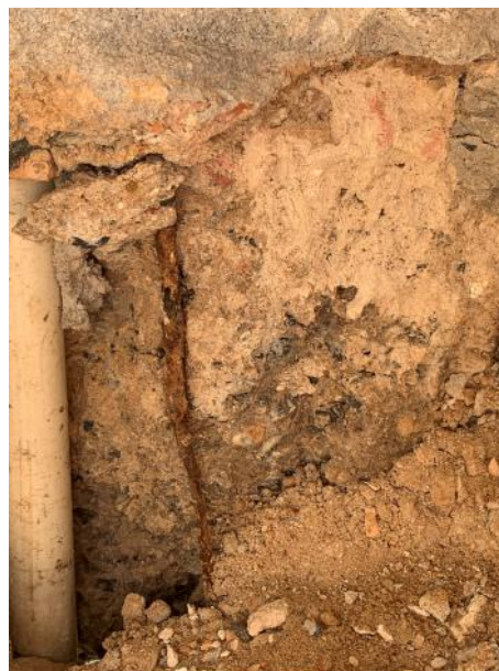
Figura 104. Armadura exposta e corroída; cobrimento deficiente; desagregação; deslocamento; falhas de concretagem.
