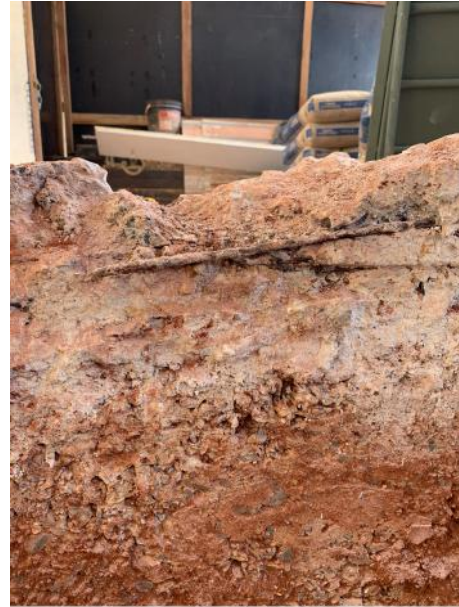
Figura 30. Armadura exposta, solta e corroída; cobrimento deficiente; falhas de concretagem.
