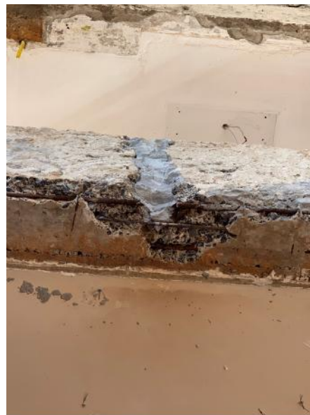
Figura 88. Estrutura da parte inferior da viga encontra-se muito deteriorada; armadura exposta e corroída; cobrimento deficiente; desagregação; deslocamento; falhas de concretagem.
