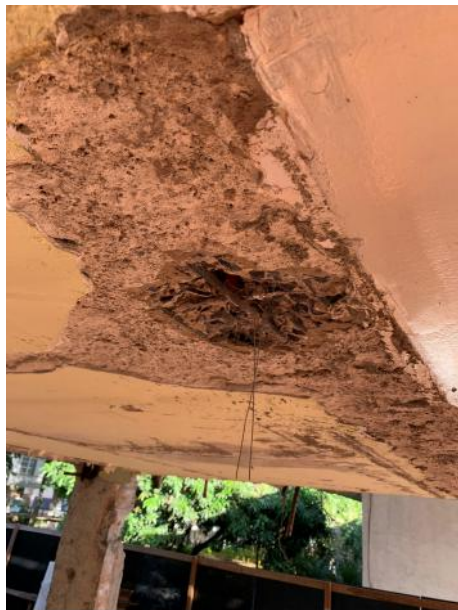
Figura 119. Armadura exposta e corroída; cobrimento deficiente; desagregação; deslocamento; falhas de concretagem.
