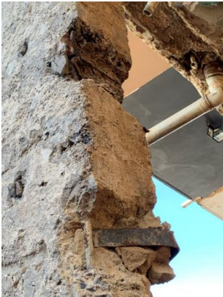
Figura 3. Desagregação; deslocamento; concretagem deficiente.
