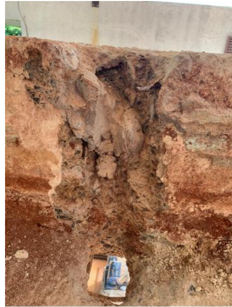
Figura 90. Armadura exposta; desagregação; deslocamento; falhas de concretagem.
