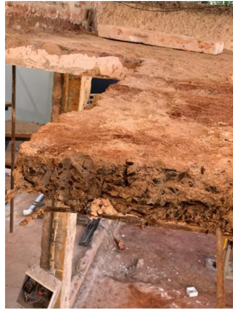
Figura 118. Armadura exposta e corroída; cobrimento deficiente; falhas de concretagem.
