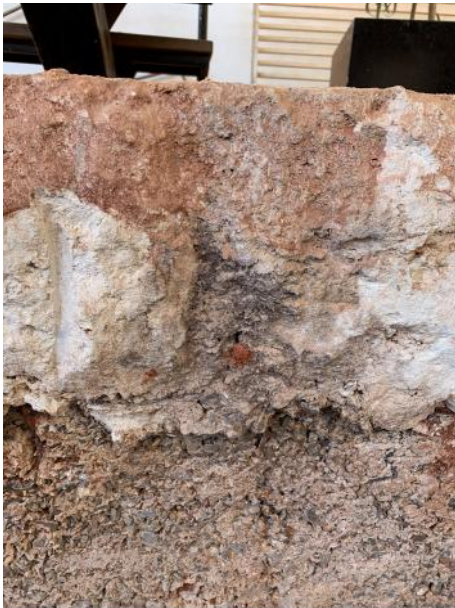
Figura 47. Desagregação; deslocamento; falhas de concretagem.
