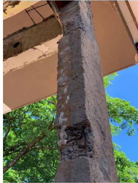
Figura 10. Armadura exposta e corroída; cobrimento deficiente; desagregação; deslocamento; falhas de concretagem.
