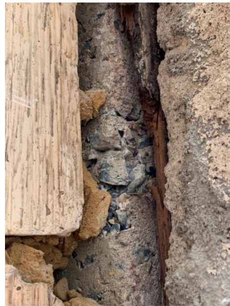
Figura 76. Desagregação; falhas de concretagem
