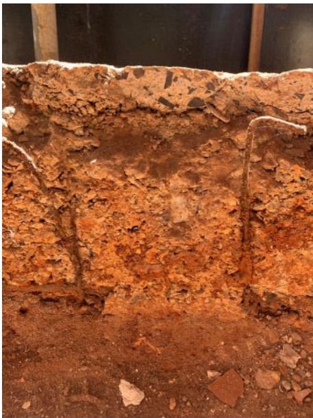
Figura 51. Armadura exposta e corroída; cobrimento deficiente falhas de concretagem.
