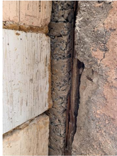
Figura 74. Desagregação; falhas de concretagem
