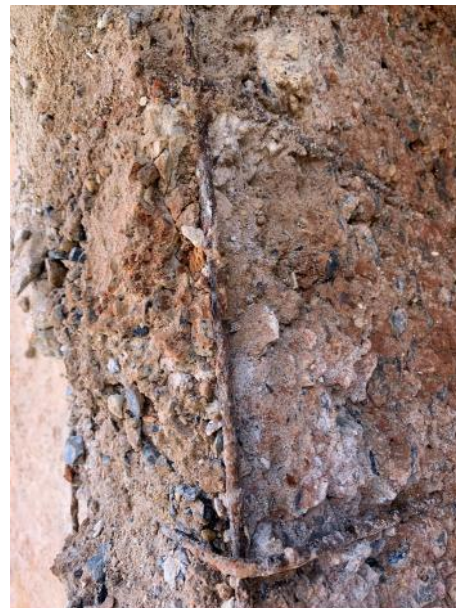
Figura 28. Armadura exposta e corroída; desagregação.
