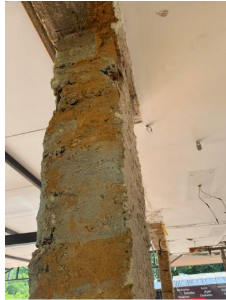
Figura 66. Falhas de concretagem.
