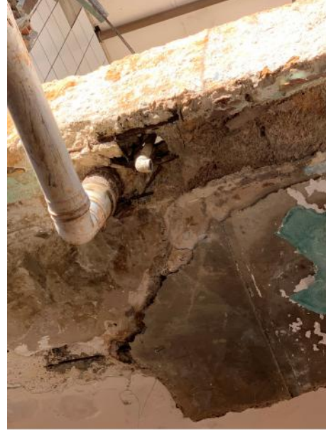
Figura 114. Armadura exposta e corroída; cobrimento deficiente; desagregação; deslocamento falhas de concretagem.
