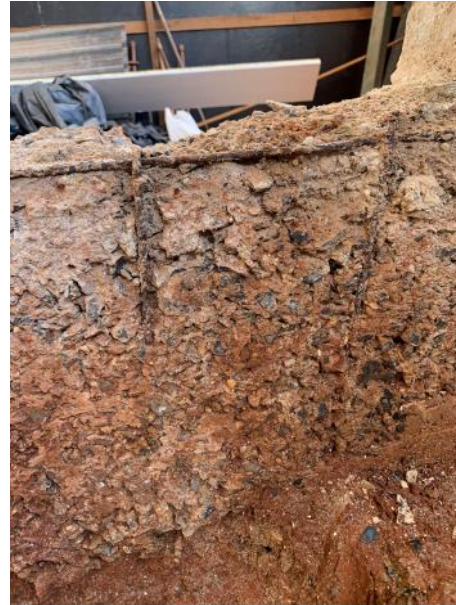
Figura 26. Armadura exposta e corroída; cobertura deficiente; falha na concretagem.
