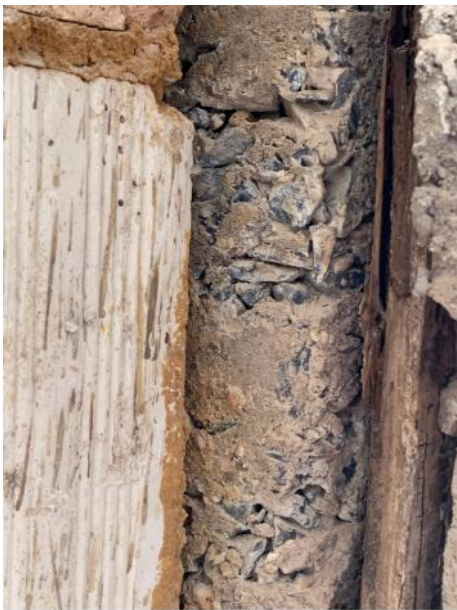
Figura 75. Desagregação; falhas de concretagem
