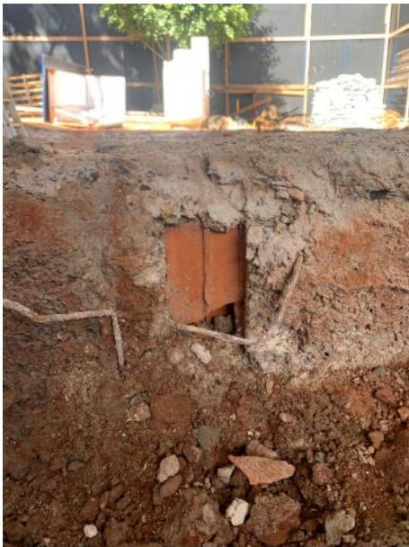
Figura 59. Armadura exposta e corroída; cobrimento deficiente; falhas de concretagem
