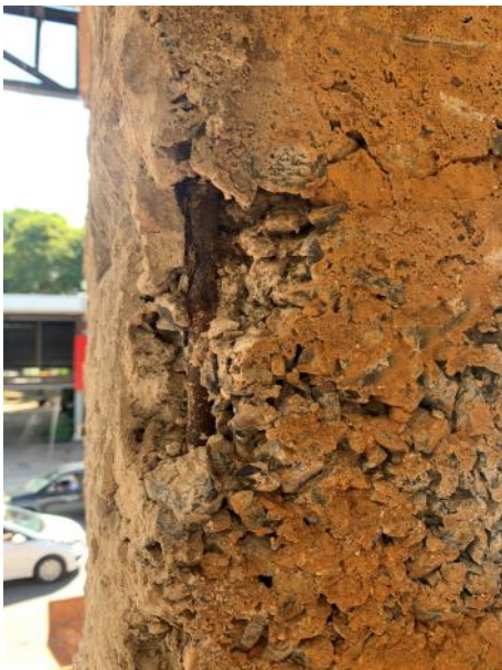
Figura 63. Armadura exposta e corroída; cobrimento deficiente; falhas de concretagem.
