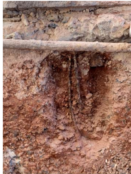
Figura 32. Armadura exposta e corroída; cobrimento deficiente; desagregação; deslocamento.
