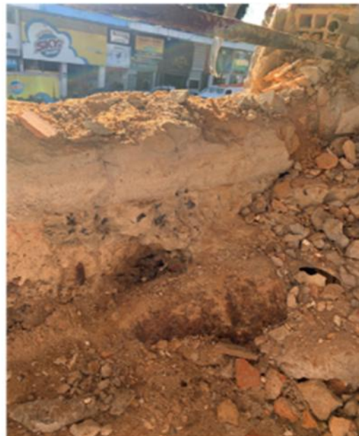
d) Desagregação; deslocamento; falhas de concretagem.
