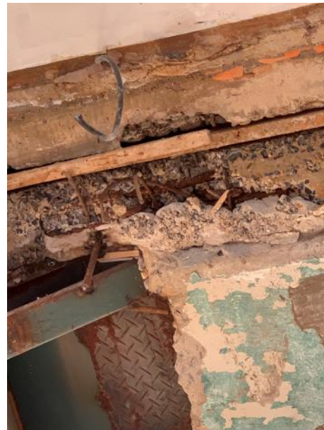
Figura 96. Estrutura da parte inferior da viga muito deteriorada; armadura exposta e corroída; cobrimento deficiente; falhas de concretagem.
