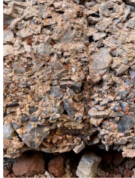
Figura 42. Armadura exposta e corroída; cobertura deficiente; falhas de concretagem.
