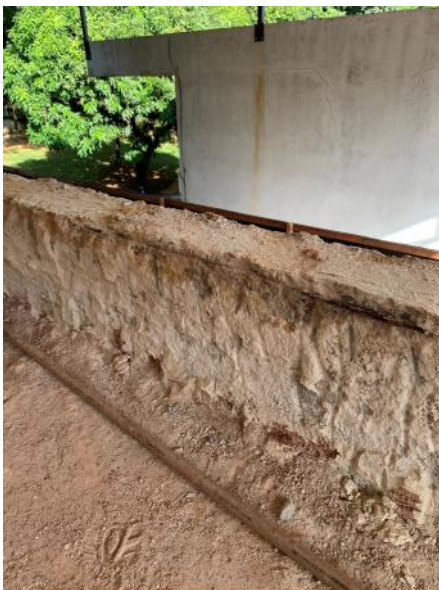
Figura 87. Armadura exposta e corroída; cobrimento deficiente; desagregação; deslocamento; falhas de concretagem; manchas.
