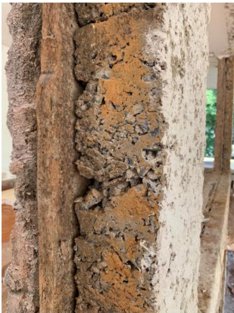
Figura 79. Desagregação, deslocamento; falhas de concretagem.
