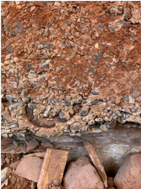
Figura 35. Armadura exposta e corroída, cobrimento deficiente; falha de concretagem; desagregação.
