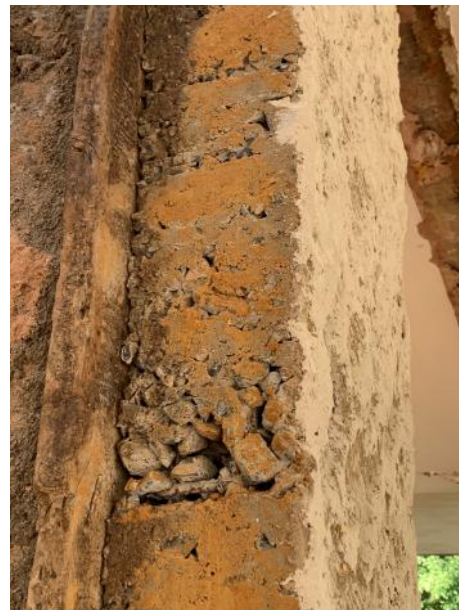
Figura 80. Desagregação, deslocamento; falhas de concretagem.
