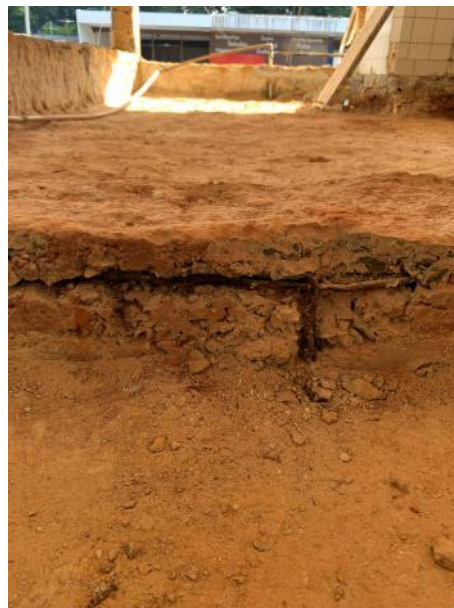
Figura 106. Armadura exposta e corroída; cobrimento deficiente; desagregação; deslocamento; falhas de concretagem
