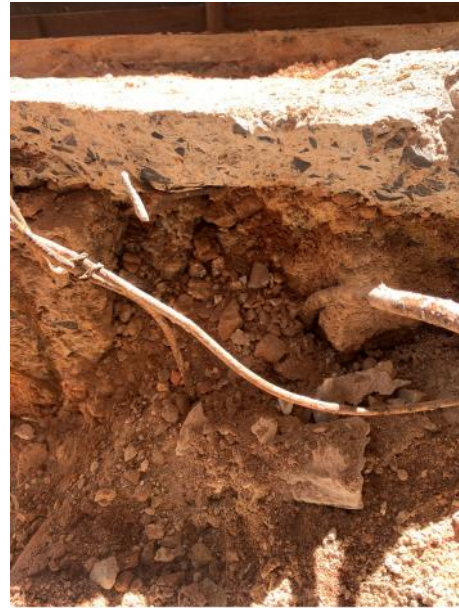
Figura 50. Desagregação; armação solta; falhas de concretagem.
