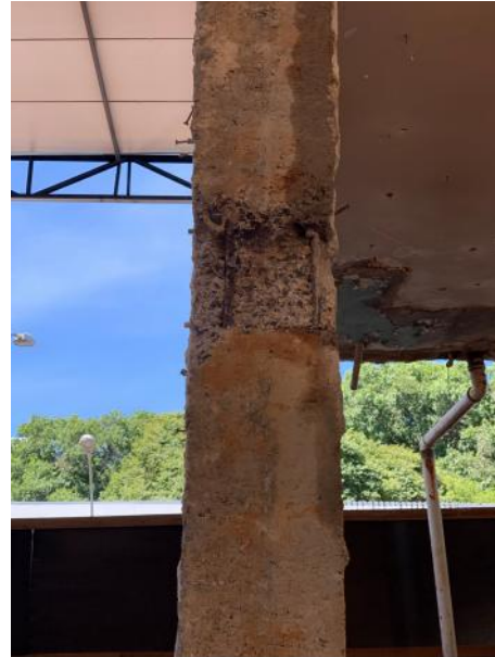
Figura 6. Armadura exposta e corroída; cobrimento deficiente.
