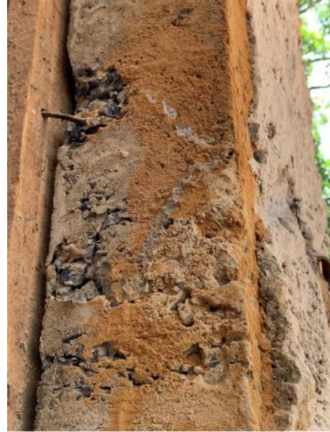
Figura 22. Falha na concretagem.
