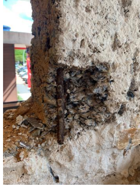
Figura 62. Estrutura da base do pilar muito deteriorada; armadura exposta e corroída; cobrimento deficiente; desagregação.
