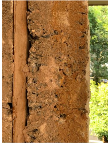
Figura 82. Desplacamento; falhas de concretagem.
