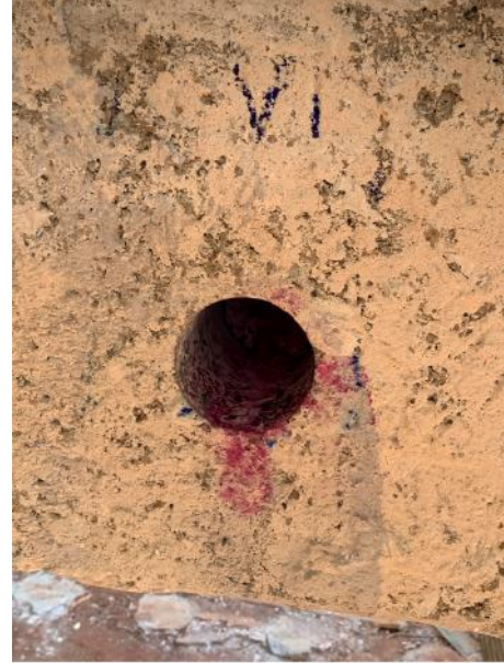
Figura 110. Ensaio de carbonatação realizado na viga, identificando que na área há carbonatação
