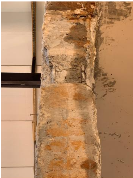
Figura 7. Desagregação; armadura exposta.
