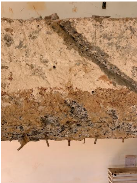
Figura 99. Armadura exposta e corroída; cobrimento deficiente; falhas de concretagem.
