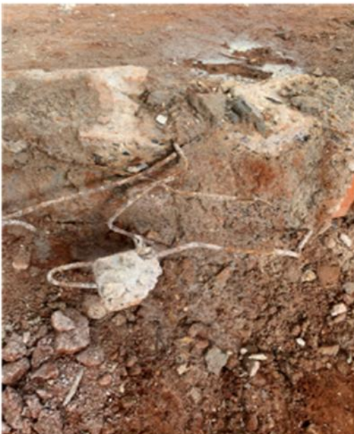
c) Armadura exposta e corroída; cobrimento deficiente; desagregação
