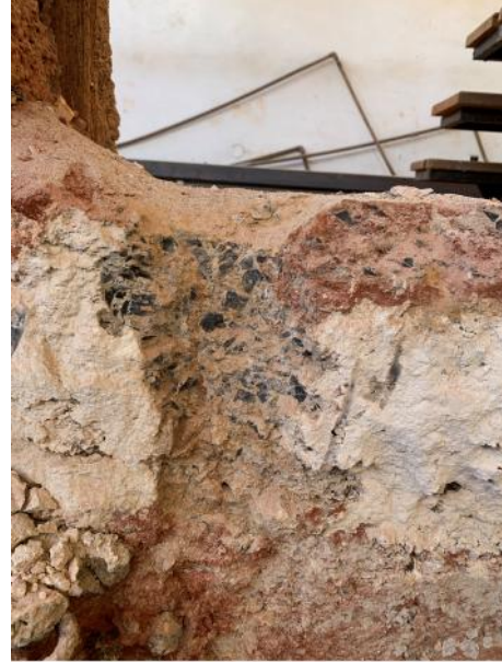
Figura 46. Desagregação; deslocamento; falhas de concretagem.
