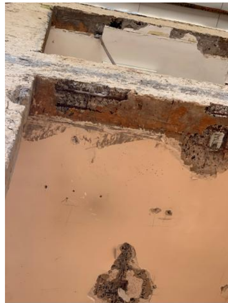
Figura 92. Estrutura da parte inferior da viga muito deteriorada; armadura exposta e corroída; cobrimento deficiente; desagregação; deslocamento; falhas de concretagem.
