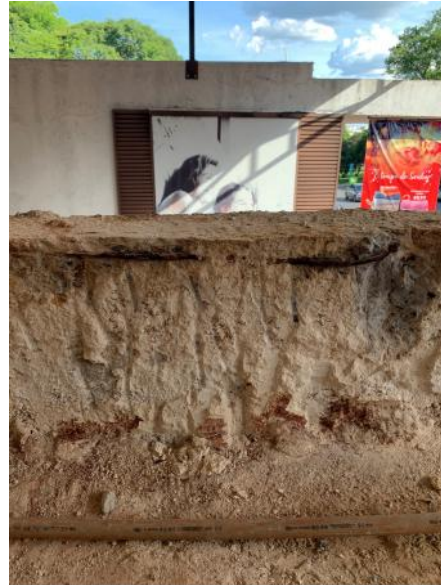
Figura 86. Armadura exposta e corroída; cobrimento deficiente; desagregação; deslocamento; falhas de concretagem; manchas.
