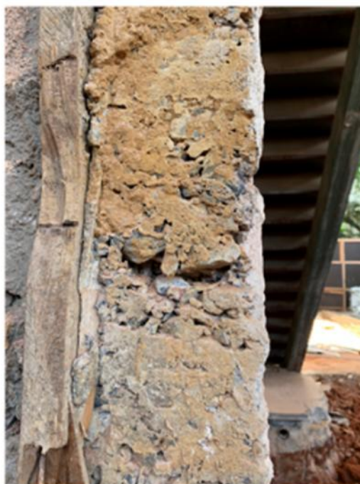
d) Cobrimento deficiente; falha na concretagem.
