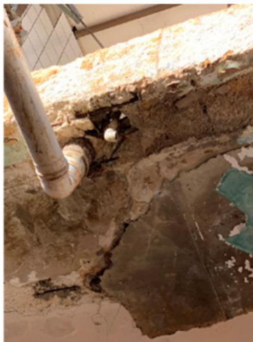
b) Armadura exposta e corroída, cobrimento deficiente, desagregação, deslocamento falhas de concretagem.
