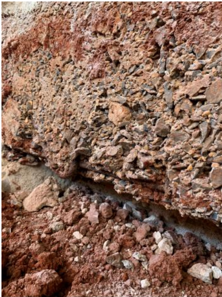
Figura 43. Armadura exposta e corroída; cobertura deficiente; falhas de concretagem; desagregação.
