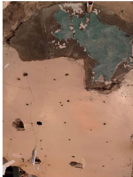
Figura 116. Armadura exposta e corroída; cobrimento deficiente; desagregação; deslocamento falhas de concretagem.
