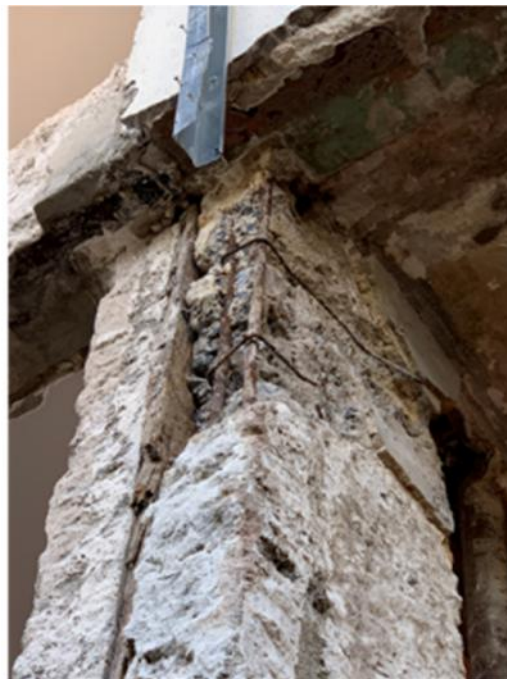
b) Armadura exposta e corroída; cobrimento deficiente; desagregação; falha na concretagem
