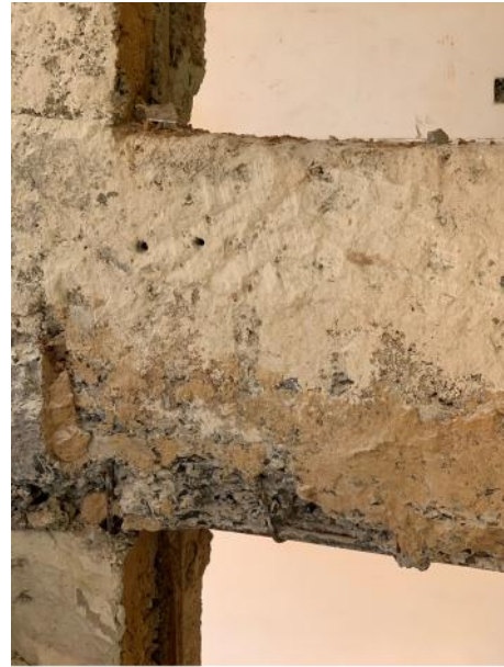
Figura 98. Armadura exposta e corroída; cobrimento deficiente; falhas de concretagem.
