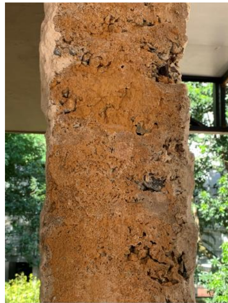
Figura 72. Armadura exposta e corroída; cobrimento deficiente; falhas de concretagem.
