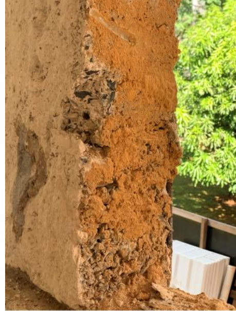
Figura 70. Desagregação; falhas de concretagem.
