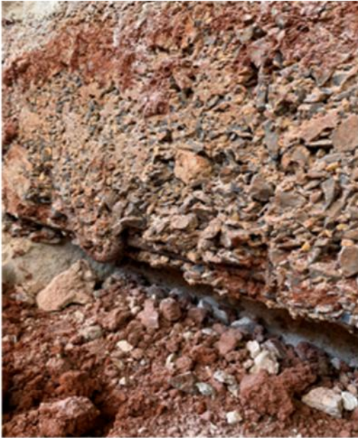
a) Armadura exposta e corroída, cobrimento deficiente; falhas de concretagem; desagregação.
