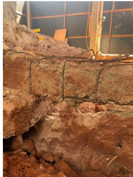
Figura 56. Estrutura muito deteriorada; armadura exposta e corroída; cobrimento deficiente; falhas de concretagem.
