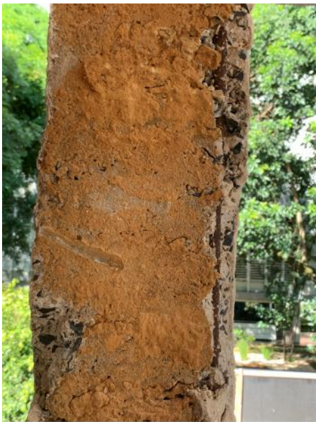
Figura 71. Armadura exposta e corroída; cobrimento deficiente; falhas de concretagem.
