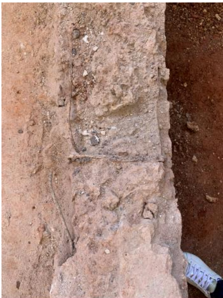
Figura 27. Armadura exposta; desagregação; deslocamento.
