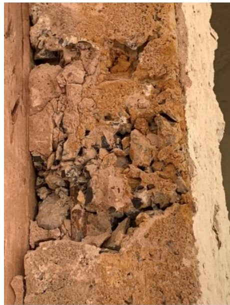
Figura 84. Armadura exposta e corroída; cobrimento deficiente; falhas de concretagem.
