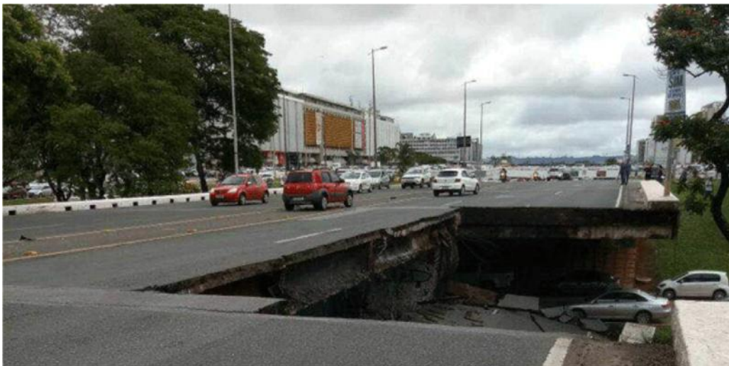
Figura 2: Queda de viaduto na região central de Brasília.
