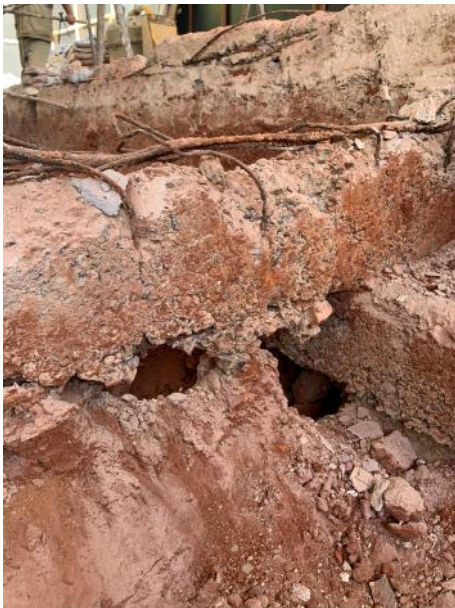
Figura 55. Estrutura muito deteriorada; armadura exposta e corroída; cobrimento deficiente; falhas de concretagem.
