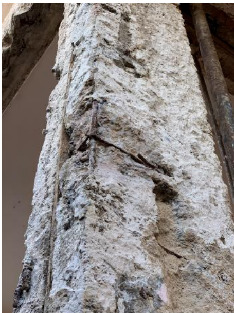
Figura 15. Armadura exposta e corroída; cobrimento deficiente; desagregação; falha na concretagem.
