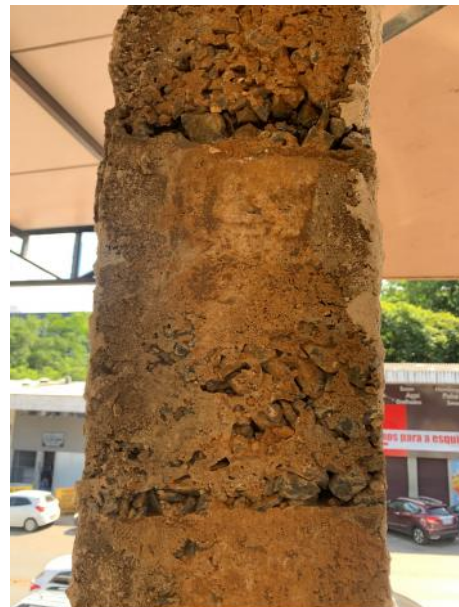
Figura 64. Falhas de concretagem.
