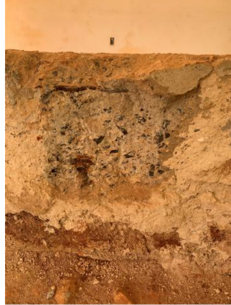
Figura 94. Armadura exposta e corroída; cobrimento deficiente; desagregação; deslocamento; falhas de concretagem.
