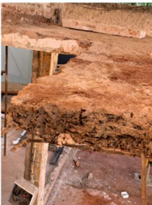
d) Armadura exposta e corroída cobrimento deficiente; falhas de concretagem.
