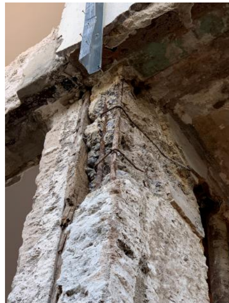
Figura 16. Armadura exposta e corroída; cobrimento deficiente; desagregação; falha na concretagem.
