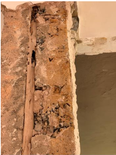
Figura 83. Armadura exposta e corroída; cobrimento deficiente; desagregação; deslocamento; falhas de concretagem.
