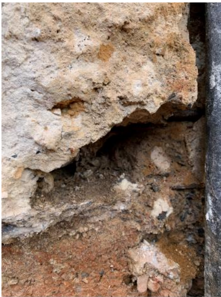
Figura 39. Desagregação; deslocamento; cobrimento deficiente; armadura exposta.
