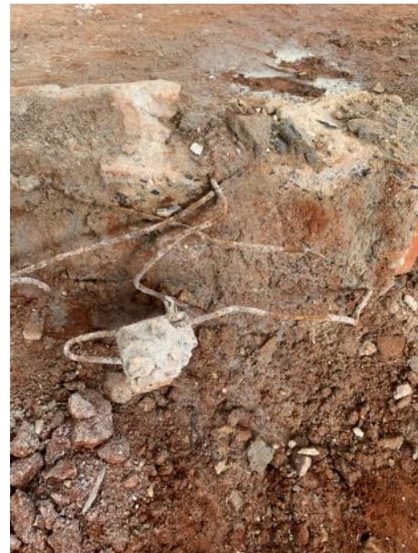
Figura 60. Armadura exposta e corroída; cobrimento deficiente; desagregação
