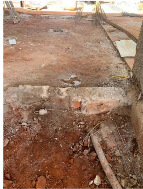
Figura 58. Armadura exposta e corroída; cobrimento deficiente; desagregação; deslocamento; falhas de concretagem
