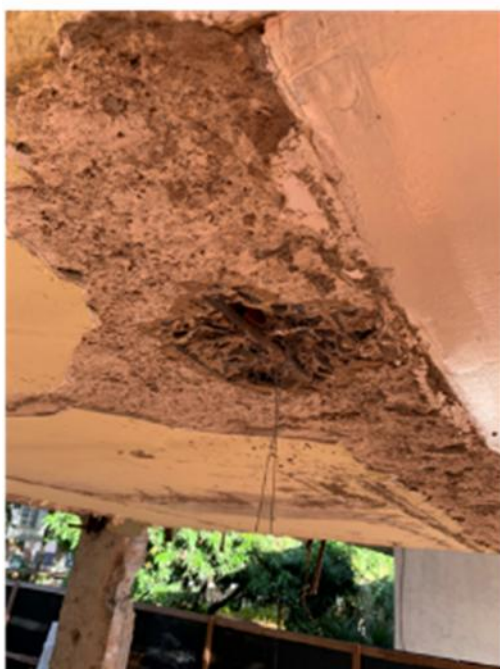
c) Armadura exposta e corroída, cobrimento deficiente, desagregação, deslocamento, falhas de concretagem.
