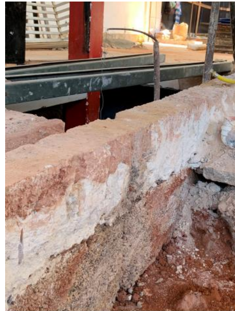
Figura 48. Desagregação; deslocamento; falhas de concretagem.
