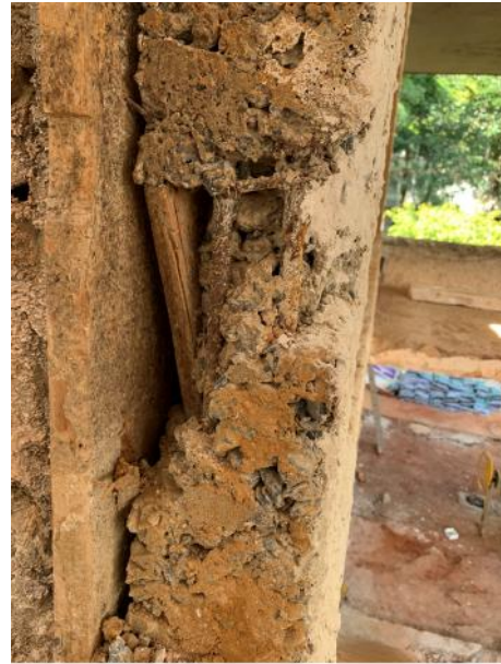
Figura 78. Armadura exposta e corroída; cobrimento deficiente; falhas de concretagem.
