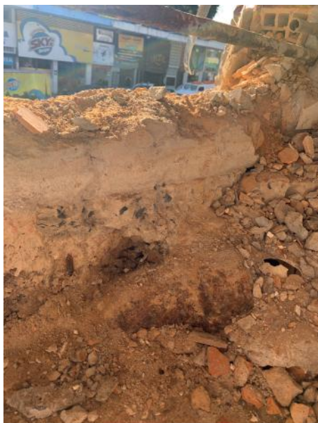
Figura 103. Desagregação; deslocamento; falhas de concretagem.
