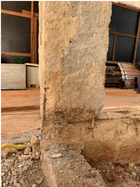
Figura 11. Base do pilar bem deteriorada e com armaduras desconectadas.
