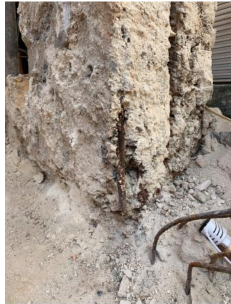
Figura 24. Armadura da base do pilar exposta, corroída e sem conexão com vigas ou fundação.
