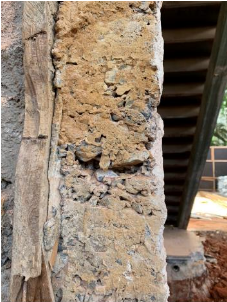
Figura 19. Cobrimento deficiente; falha na concretagem.
