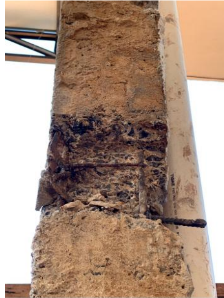
Figura 2. Armadura exposta e corroída; cobertura deficiente.
