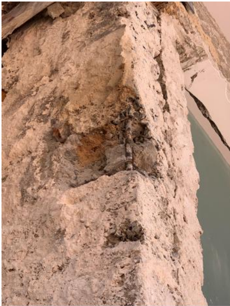
Figura 23. Armadura exposta e corroída; cobrimento deficiente; desagregação; deslocamento.
