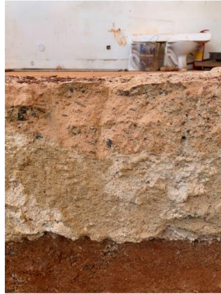
Figura 38. Desagregação; deslocamento; falhas de concretagem.
