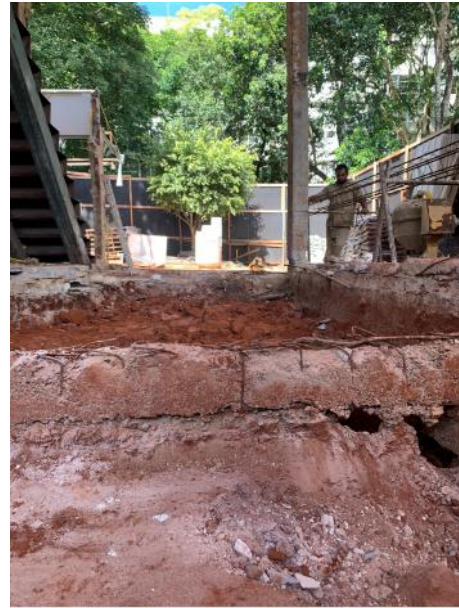
Figura 54. Armadura exposta e corroída; cobrimento deficiente; desagregação; deslocamento; falhas de concretagem.
