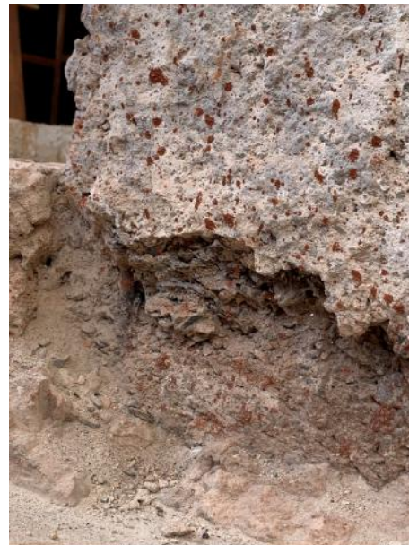
Figura 8. Desagregação; falha na concretagem.
