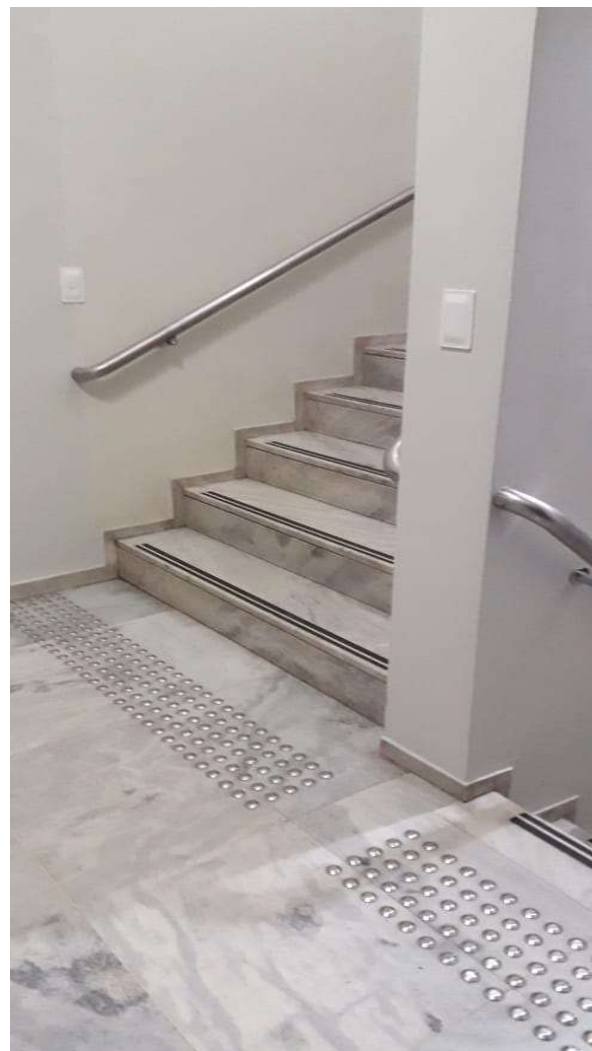
ESCADA DE SERVIÇO
