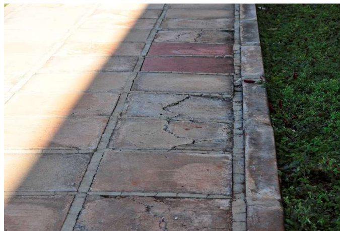
TRECHOS DANIFICADOS NAS CALÇADAS
