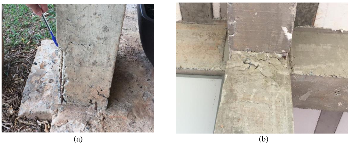
Figura 35 - Armadura exposta (a) e esmagamento (b)
