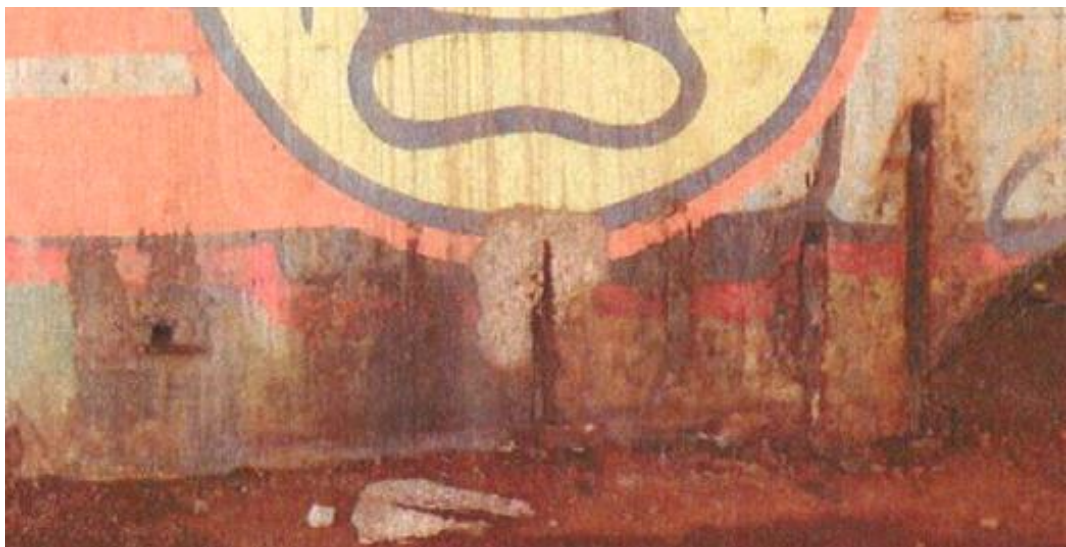
Figura 44 – Corrosão da armadura
