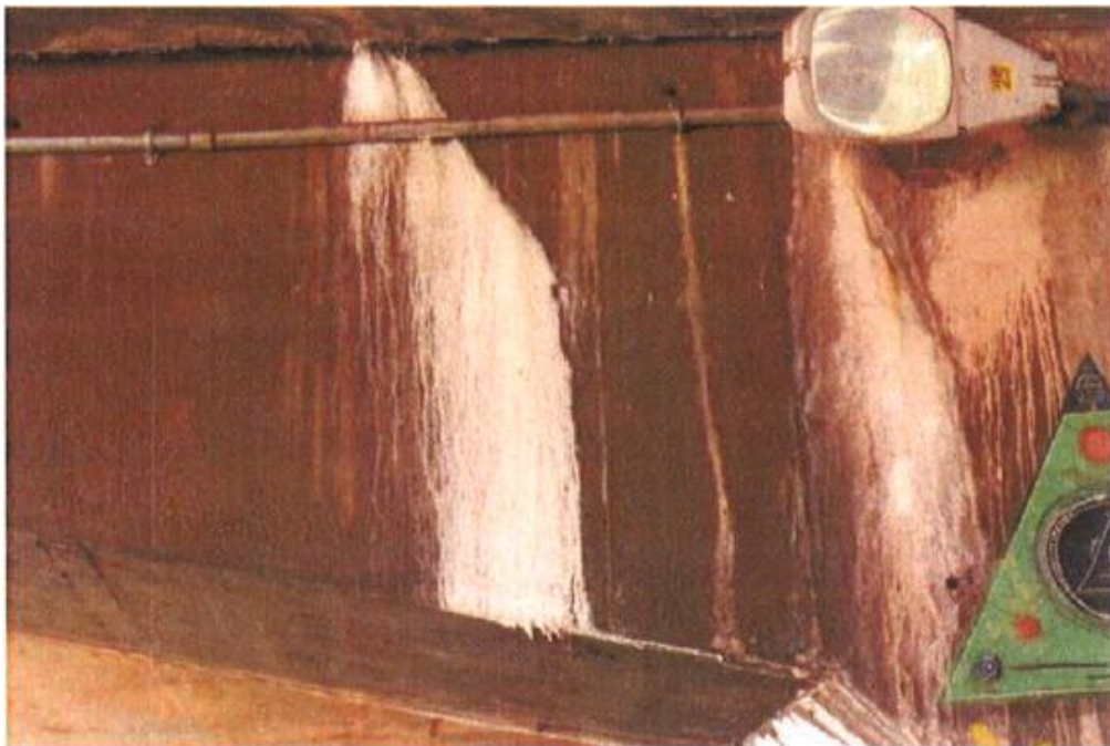
Figura 42 – Eflorescência e infiltração
