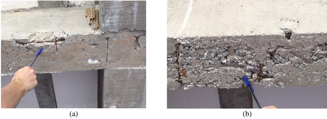
Figura 28 - Presença de corrosão nas armaduras das vigas
