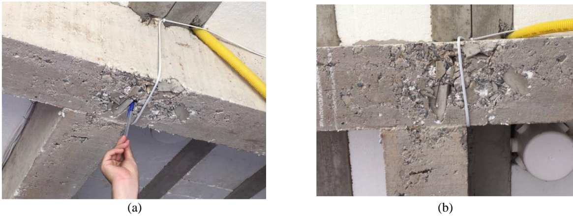
Figura 29 - Segregação do concreto da viga do subsolo
