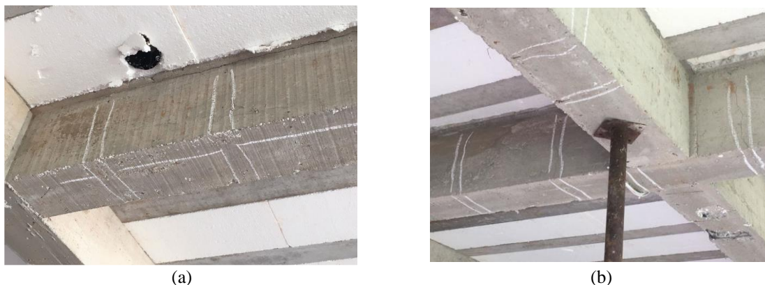
Figura 31 - Fissuras nas vigas do teto subsolo
