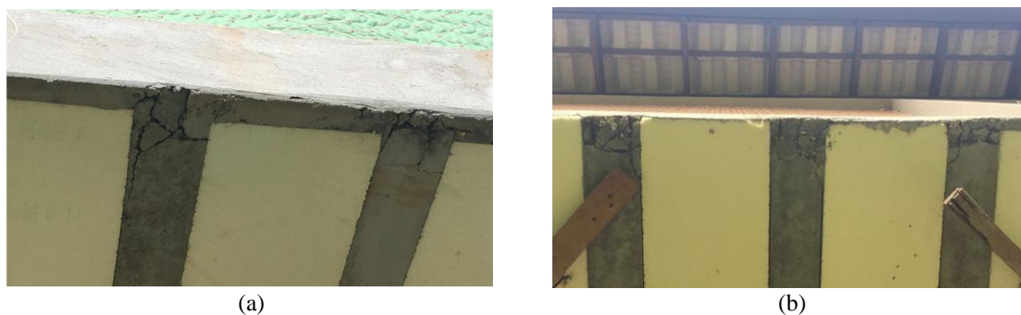
Figura 36 - Fissuras e deslocamento
