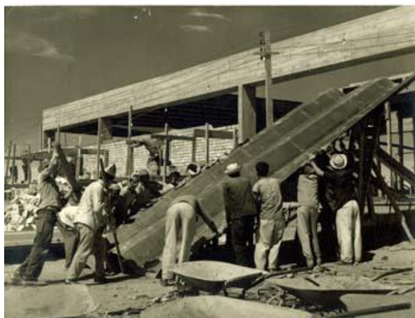
Figura 42: Construção da Faculdade de Educação. Fonte: Universidade de Brasília. Arquivo Central. AtoM UnB. https://atom.unb.br/index.php/00112-16 .
