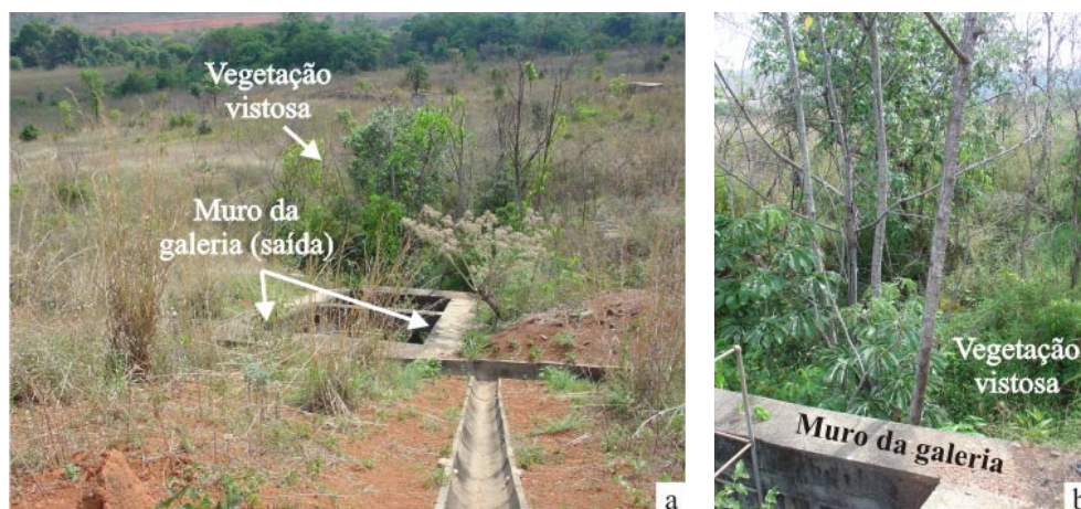
Figura 5.7 – Detalhe da estrutura de saída da galeria da tomada d'água: a) poço de acesso à galeria (talude de jusante) com indicações de presença de água; b) detalhe da vegetação a jusante da galeria.
