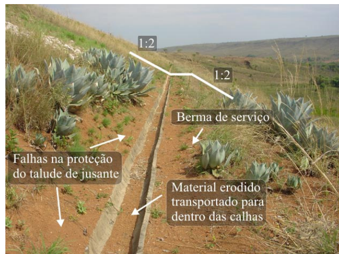
Figura 5.20 - Talude de jusante: falhas na proteção e constatação de início de erosão.
