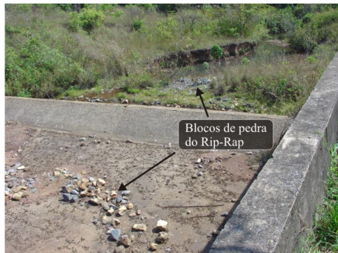
Figura 5.22 - Deslocamento do material do Rip-Rap pela força da água.
