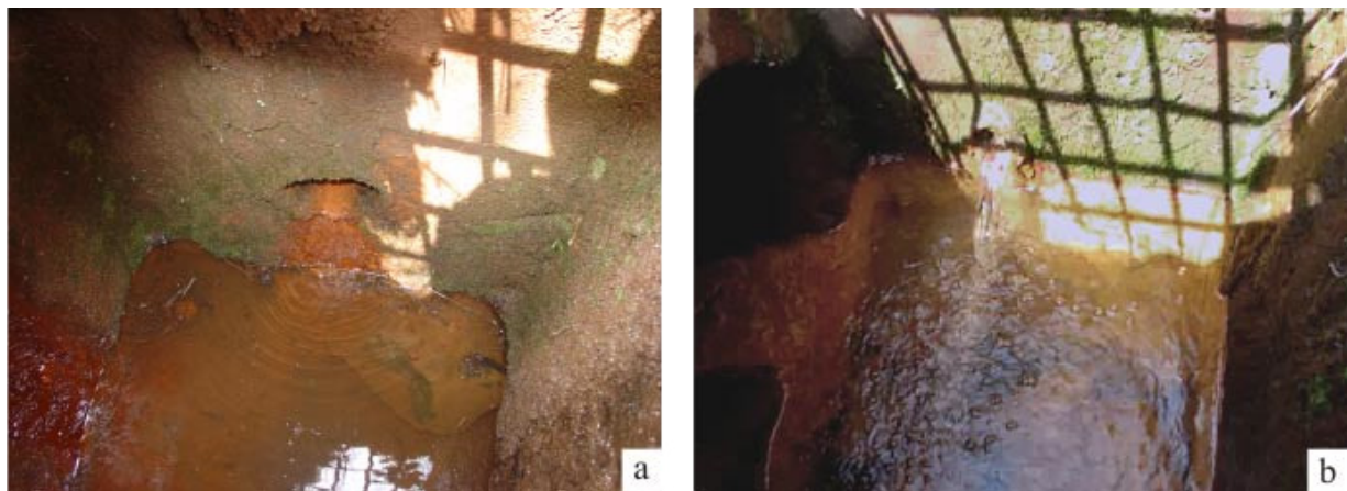
Figura 5.10 – Poço de inspeção da vazão de saída dos drenos, localizado próximo à ombreira direita (a) e próximo a ombreira esquerda (b).
