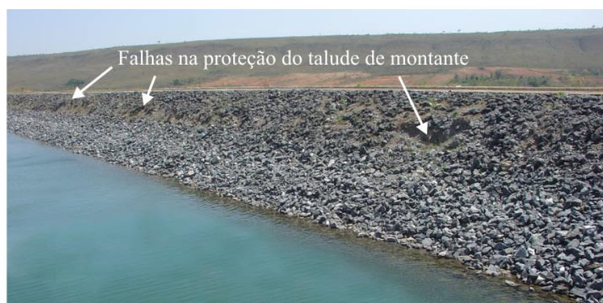
Figura 5.19 - Falhas na proteção do talude de montante e surgimento de buracos de erosão.
