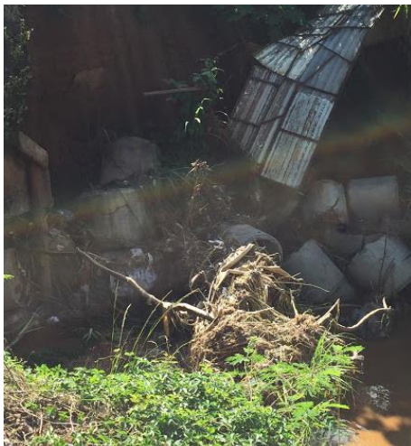
Foto 20. Margens do córrego Cesário
