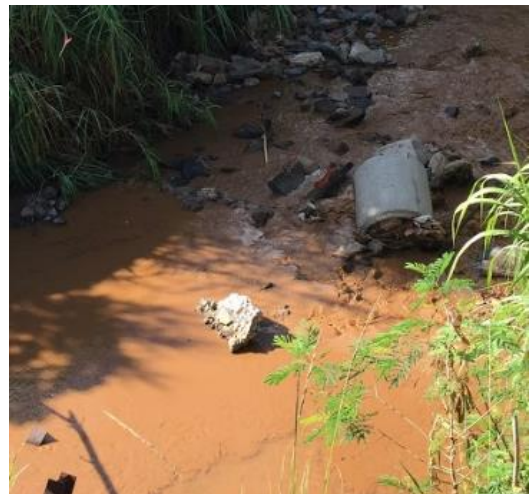
Foto 21. Acúmulo de lixo no leito do córrego Cesários
