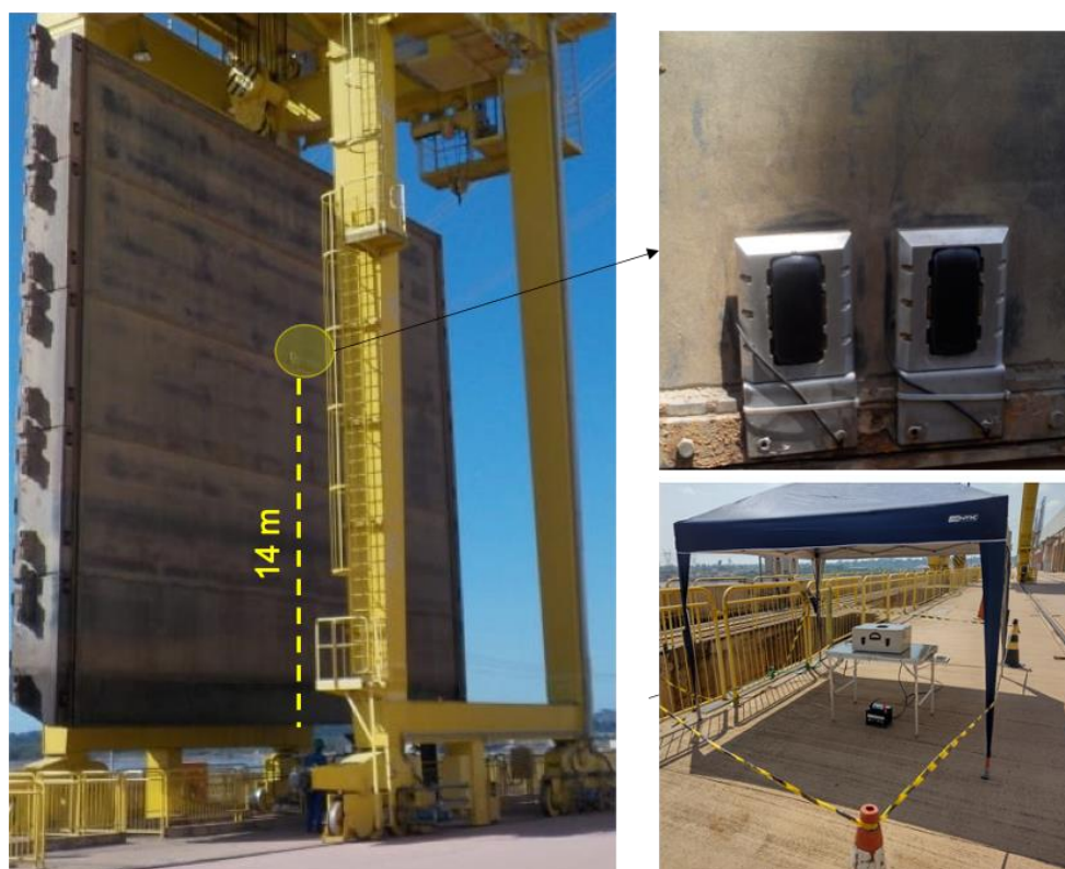
Figura 13. Transdutores hidroacústicos fixados no plano de face da comporta vagão da UHE Jirau, acoplados ao PADS. ( 9^{\circ}16'06.7''S 64^{\circ}38'41.9''W ).
