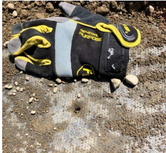
Figura 2.6 - Dano causado por perfurações durante a colocação do material sobrejacente (Beck, 2019).
