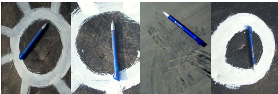
Figura 2.7 - Danos em Geomembranas: entalhe, indentação, danos visíveis e furo (Rebelo, 2008).
