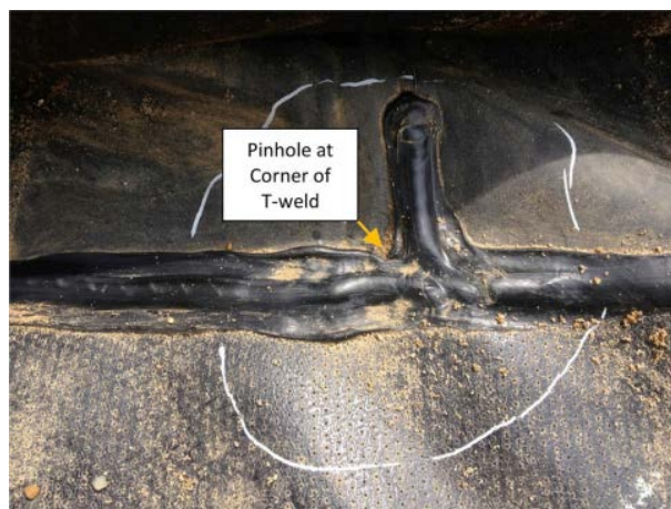
Figura 2.9 - Orifício localizado em solda por extrusão (Beck, 2019).
