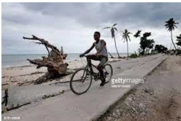
Fig.21 : Image de la route menant à la plage Pointe-Sable endommagée.
