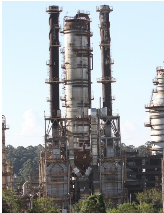
Figura 4.4: Torre da unidade de destilação.
