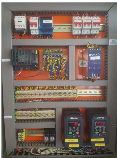
Figura 4.3: Quadro elétrico da bancada utilizada.
