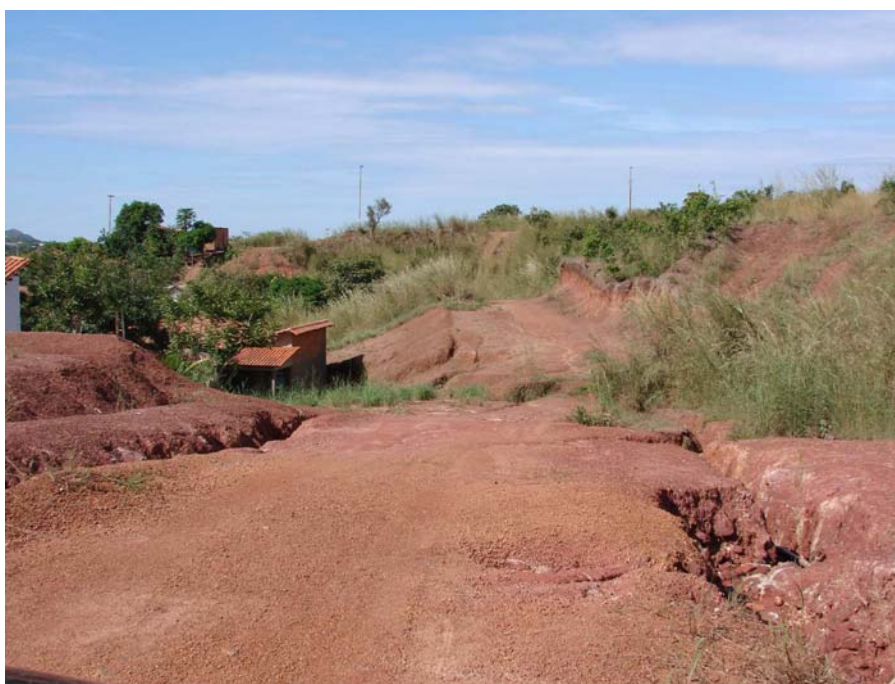
FOTO 5: Processo erosivo em via do Jardim Aurenny III
