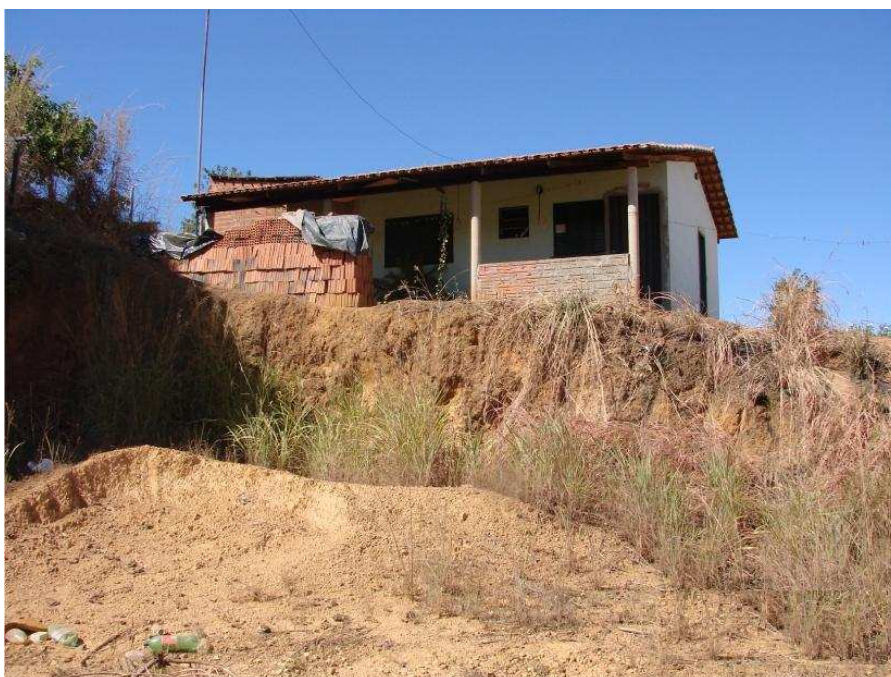
FOTO 6: Casa contígua a encosta com risco de desestabilização
