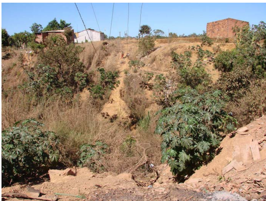
FOTO 7: Encosta erodida com risco de desestabilização
