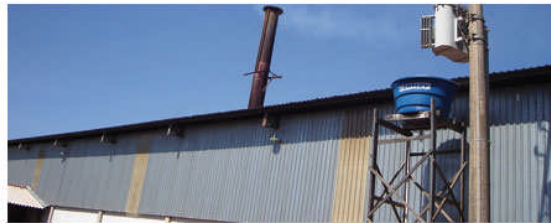
D2 - Transformadores de tensão na fábrica
