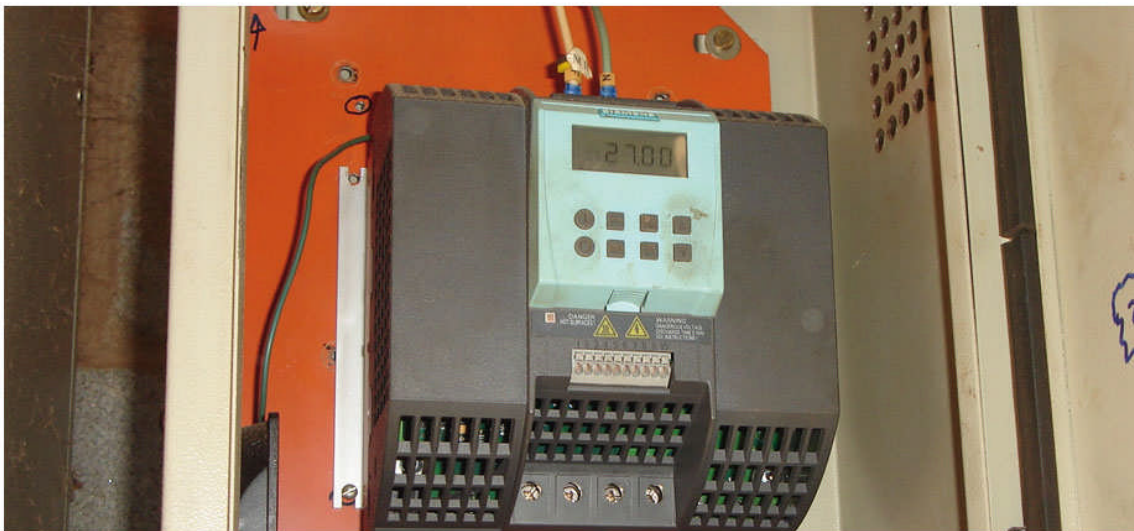
D5 - Inversor de frequência dos motores
