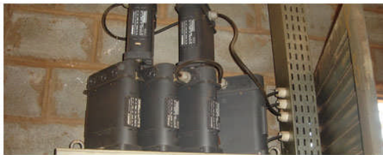
D4 - Banco de capacitores para \cos \phi
