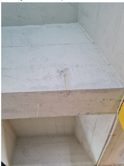
Figura 98 – Infiltração devido falha de impermeabilização da cobertura.
