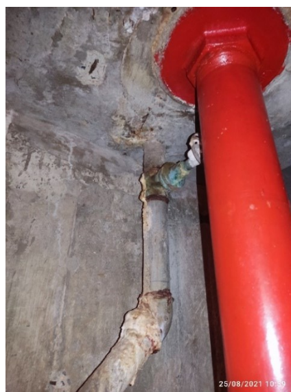
Figura 145 – Oxidação e vazamento do registro de abastecimento.
