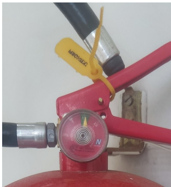
Figura 30 – Unidade extintora lacrada e com pressão dentro dos limites.
