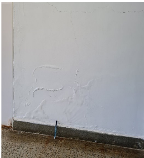
Figura 129 – Empolamento da pintura.
