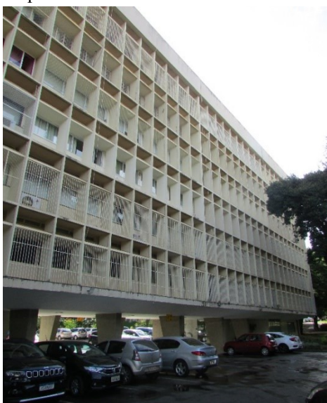
Figura 51 – Degradação do revestimento de pintura da fachada – fachada frontal.
