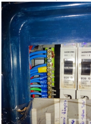
Figura 111 – Quadros de distribuição (circuito de tomadas).
