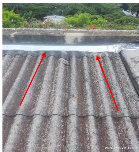
Figura 24 – Ausência de impermeabilização do rufo de concreto.
