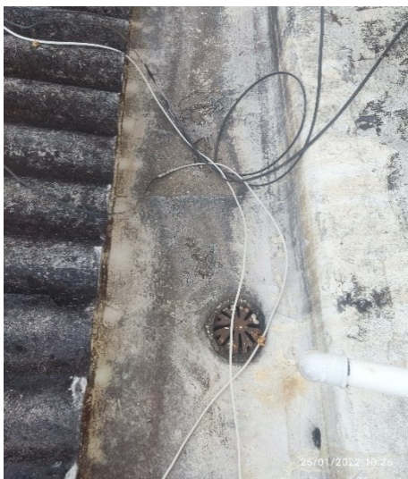
Figura 25 – Ausência de manutenção e acúmulo de sedimentos.
