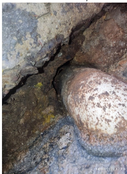
Figura 74 – Vazamentos nas caixas de gordura, abaixo da tubulação.
