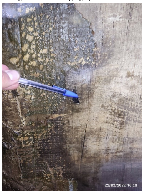
Figura 65 – Desagregação da manta.
