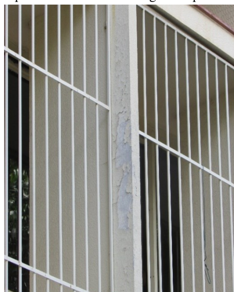
Figura 52 – Degradação do revestimento de pintura da fachada – imagem ampliada.
