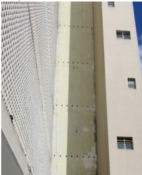
Figura 49 – Degradação do revestimento de pintura da fachada – torre anexa.
