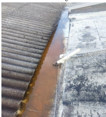
Figura 23 – Declividade irregular da calha, com acúmulo de água.
