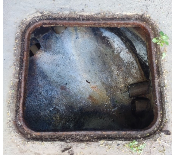
Figura 147 – Caixa de inspeção e passagem.
