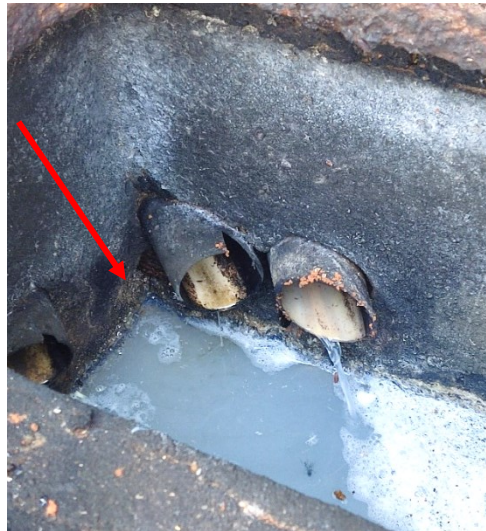
Figura 149 – Vazamentos nas caixas de gordura, abaixo da tubulação.
