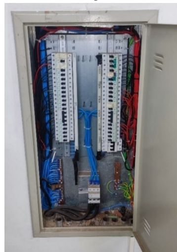
Figura 109 – Quadro geral de baixa tensão.
