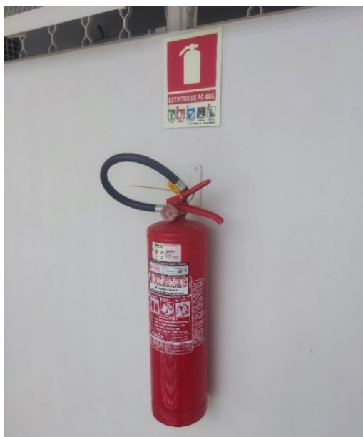
Figura 29 – Extintor de incêndio do tipo ABC, devidamente sinalizado.
