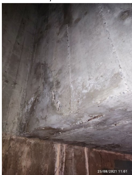
Figura 144 – Sinais de antigos vazamentos e oxidação da armadura.
