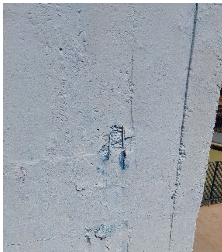
Figura 142 – Oxidação da armadura.
