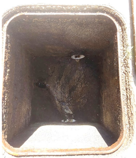
Figura 146 – Caixa de inspeção e passagem.
