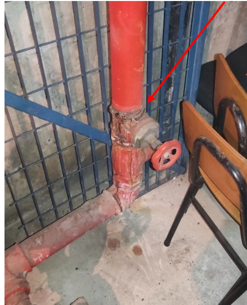
Figura 105 – Sinal de vazamento e oxidação.
