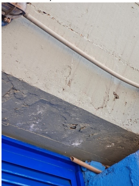
Figura 123 – Repulsão do concreto, devido a oxidação das armaduras.
