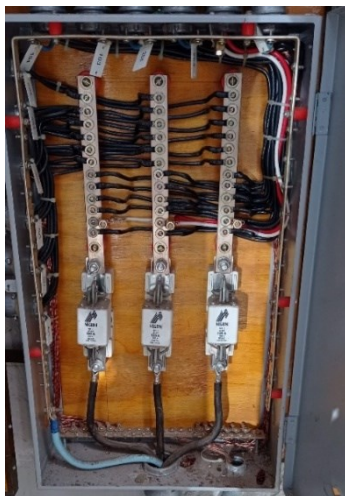
Figura 39 – Quadro de distribuição coletivo de medidores.
