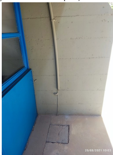
Figura 117 – Ausência de proteção da cordoalha.
