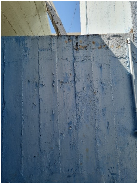
Figura 121 – Degradação do revestimento de pintura da fachada.
