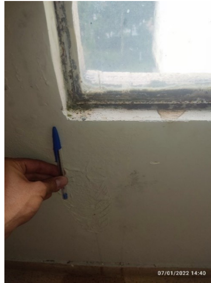
Figura 58 – Infiltração da esquadria metálica.
