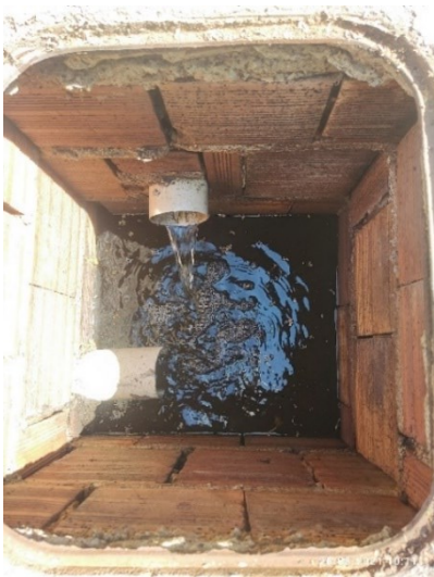
Figura 148 – Ausência de revestimento na caixa de sabão.
