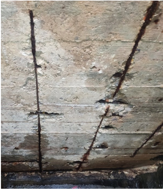
Figura 67 – Corrosão das armaduras da laje.
