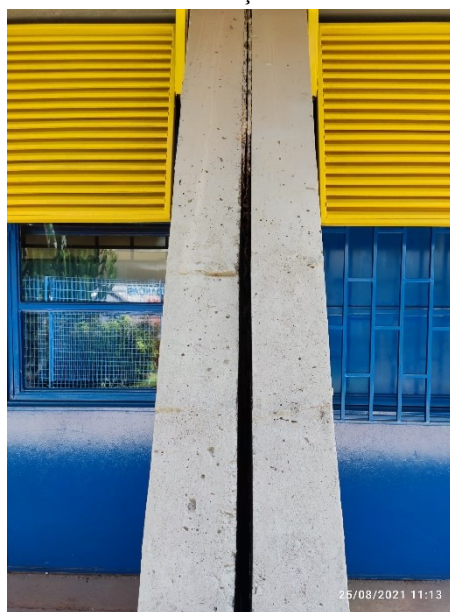
Figura 155 – Ausência de selante na junta de dilatação.
