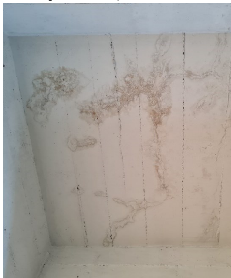
Figura 99 – Infiltração devido falha de impermeabilização da cobertura.
