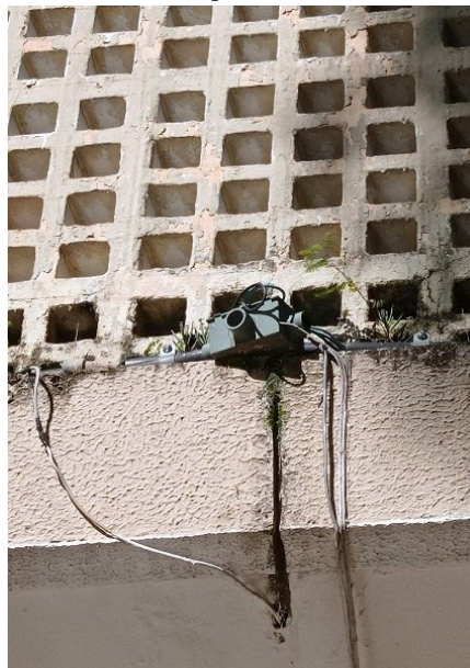
Figura 44 – Cabos expostos, fora de eletrodutos.
