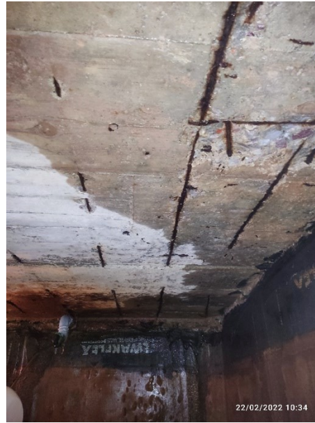
Figura 68 – Corrosão das armaduras da laje.
