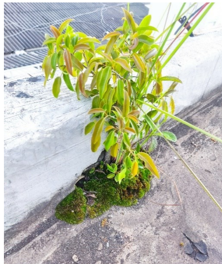
Figura 26 – Vegetação no interior do coletor pluvial.
