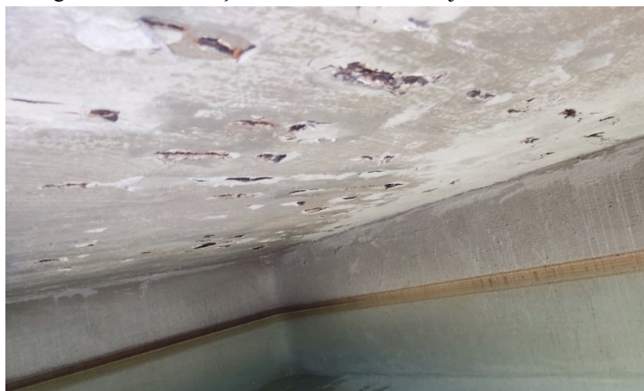
Figura 143 – Oxidação das armaduras da laje do reservatório.
