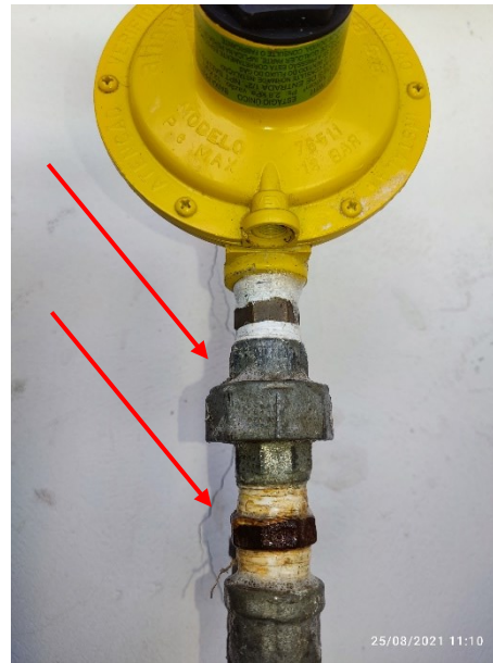
Figura 107 – Peças com vazamento.
