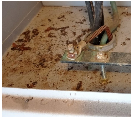
Figura 38 – Sujidades no interior do quadro de entrada de energia.
