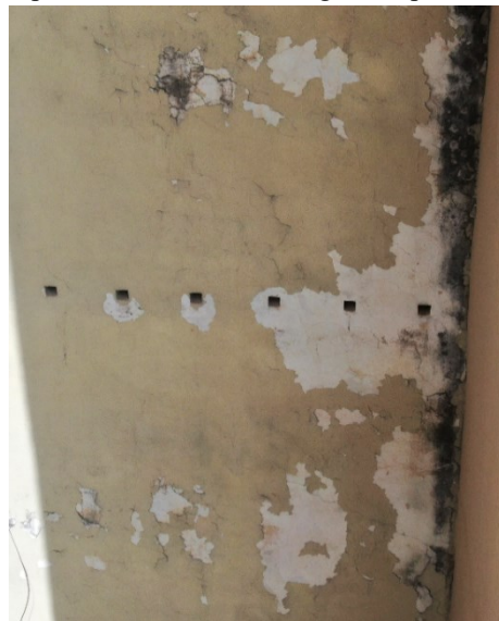
Figura 50 – Degradação do revestimento de pintura da fachada – imagem ampliada.
