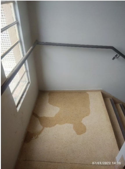
Figura 57 – Infiltração da esquadria metálica.
