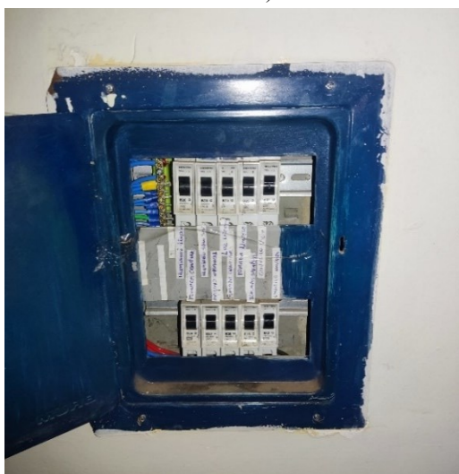
Figura 110 – Quadros de distribuição (circuito de tomadas).
