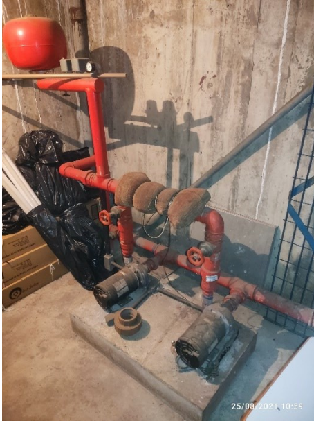
Figura 104 – Sistema de bombas.
