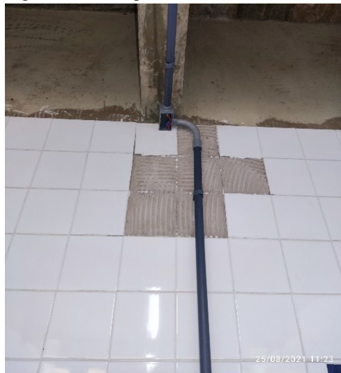
Figura 130 – Deslocamento de revestimento.
