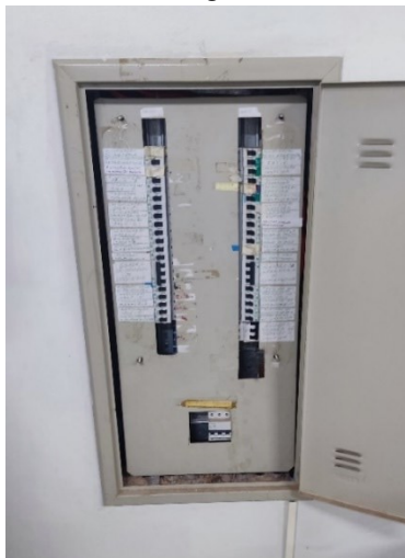
Figura 108 – Quadro geral de baixa tensão.
