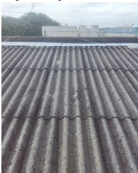
Figura 19 – Desgaste natural das telhas.
