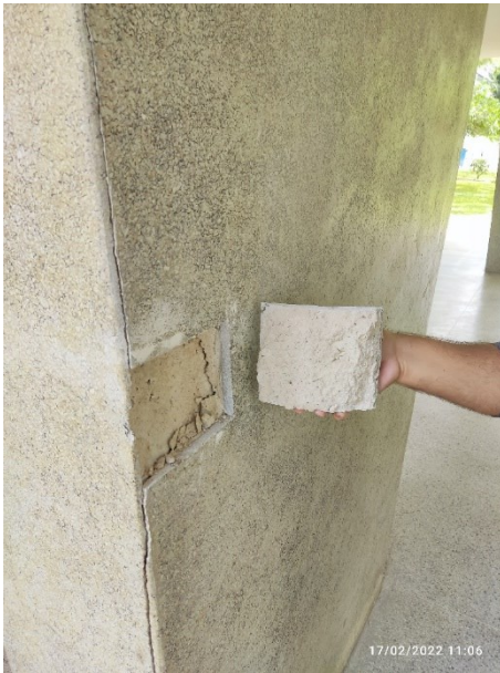
Figura 76 – Prospecção do local da trinca no revestimento do pilar.
