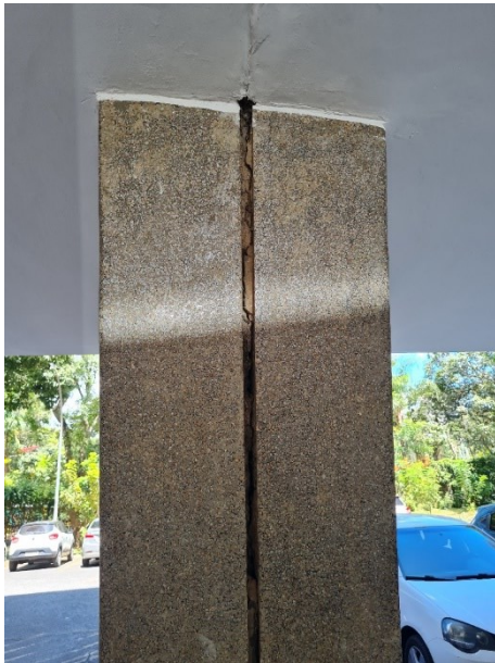
Figura 78 – Ausência de selante na junta de dilatação.
