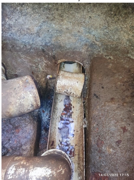
Figura 73 – Fluxo de esgoto direcionado ao solo devido a deterioração da base.
