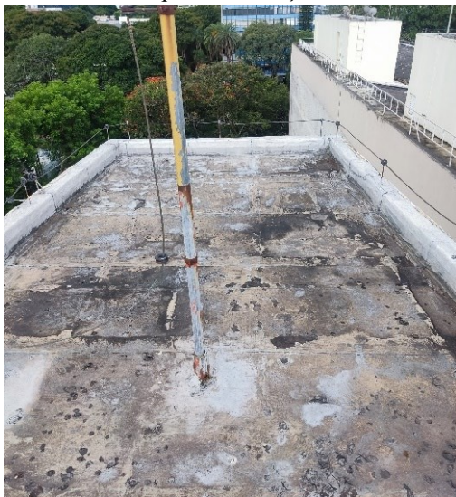
Figura 27 – Desgaste da manta asfáltica de impermeabilização.
