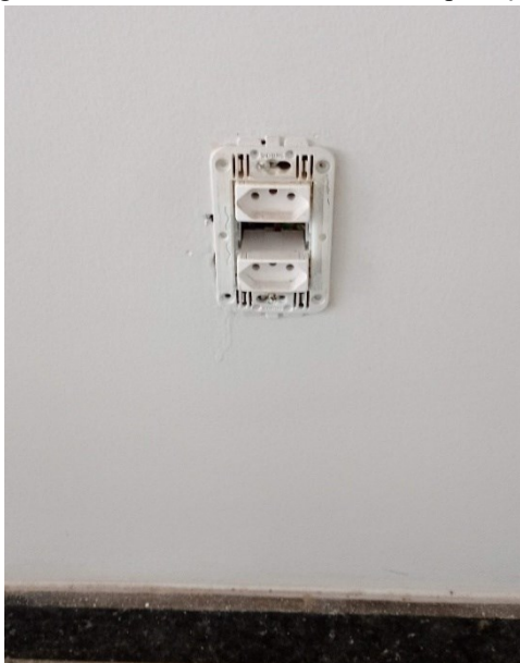
Figura 43 – Ausência de acabamento de proteção.
