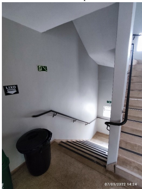
Figura 35 – Escada de emergência, com falhas na fita antiderrapante.
