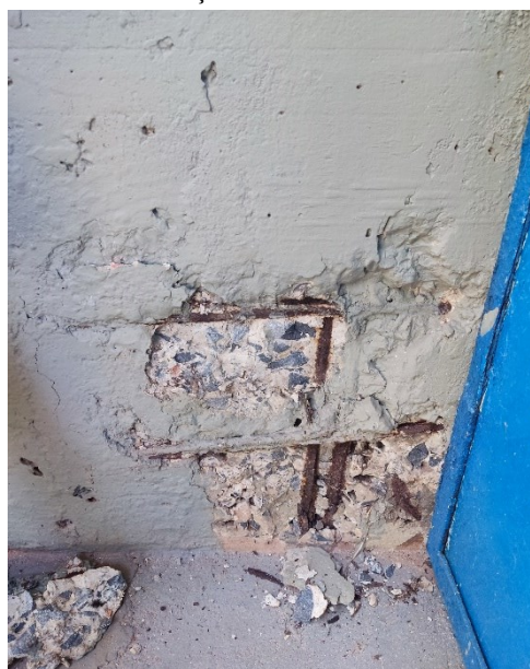
Figura 124 – Repulsão do concreto, devido a oxidação das armaduras.
